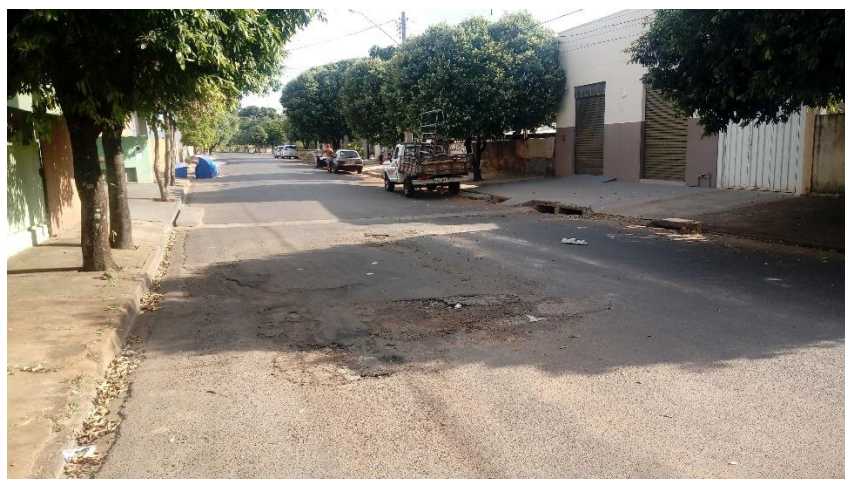
Figura 33 – Vista geral do Ponto de Alagamento 11.
