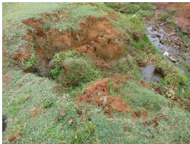
Foto 7.3.10 – Erosão causada pela dissipação
