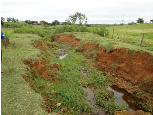
Foto 7.3.9 – Erosão causada pelo lançamento
