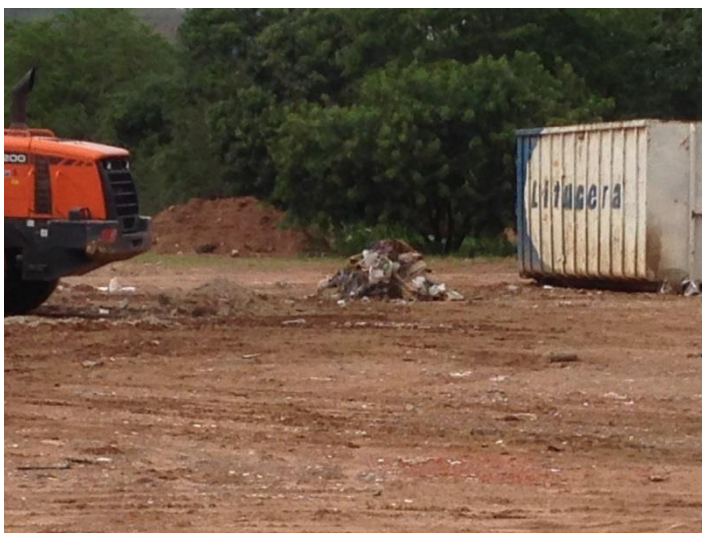
Figura 34: Estação de Transbordo de Inertes (2).
