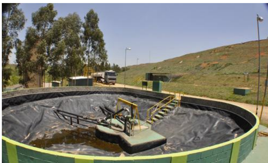
Figura 16: CGR Paulínia da empresa Estre Ambiental S.A. (lagoa de tratamento de chorume)
