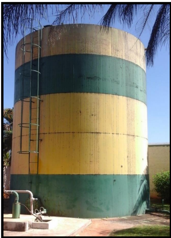
Imagem 22 – Reservatório Saida Catanduva (R6)
