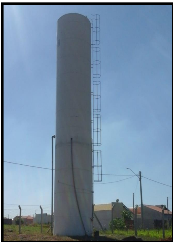
Imagem 27 – Reservatório Residencial Urupês II (R12)
