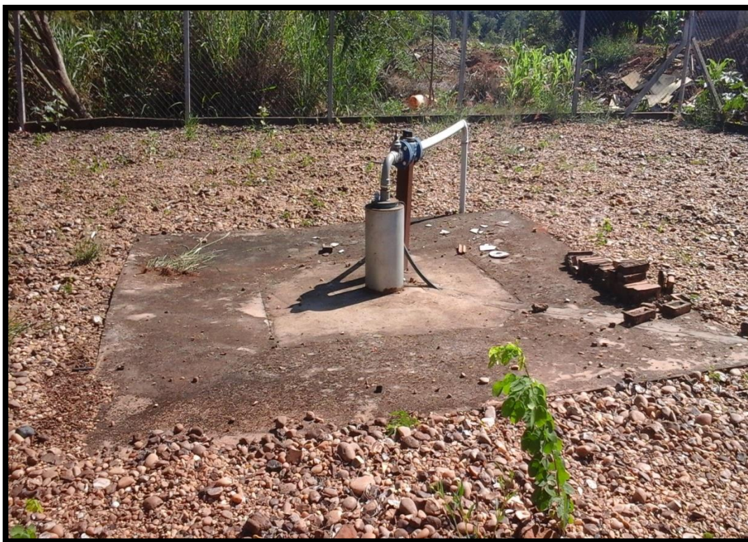
Imagem 14 – Poço Residencial Pôr do Sol (P11)
