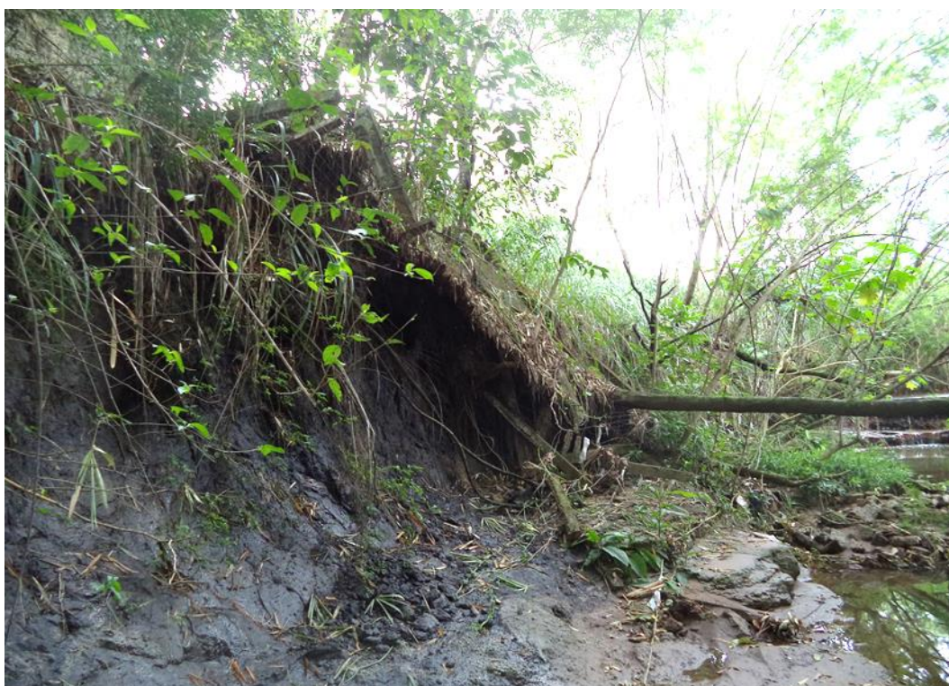
Imagem 58 – Margem desestabilizada do Córrego Santa Rosa causando o desmoronamento de árvores
