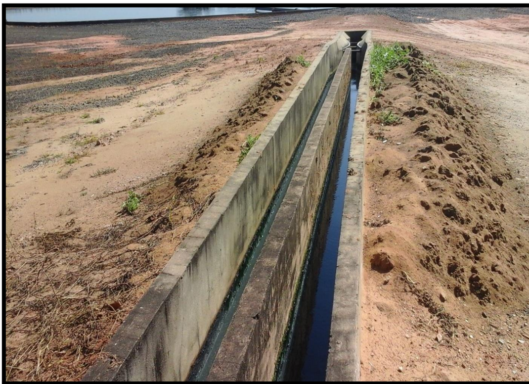
Imagem 31 – Caixa de areia e calha parshall
