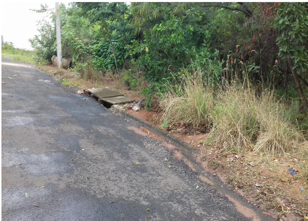
Imagem 66 – Boca de lobo existente na Rua Maria Jordano
