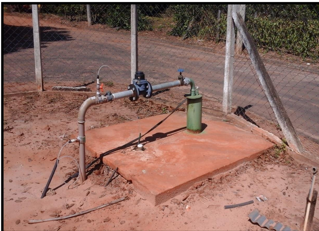
Imagem 11 – Poço Distrito São João do Itaguaçu (P8)
