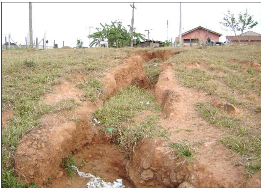
Imagem 52 – Vista da erosão
