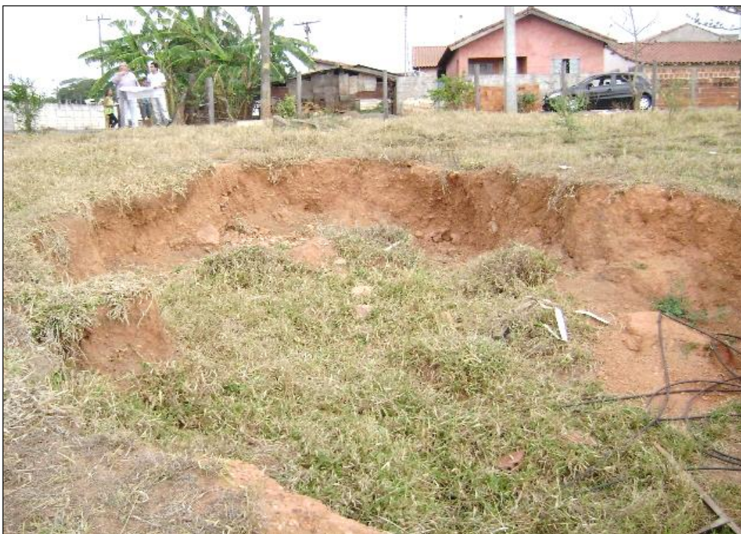
Imagem 51 – Vista do início da erosão
