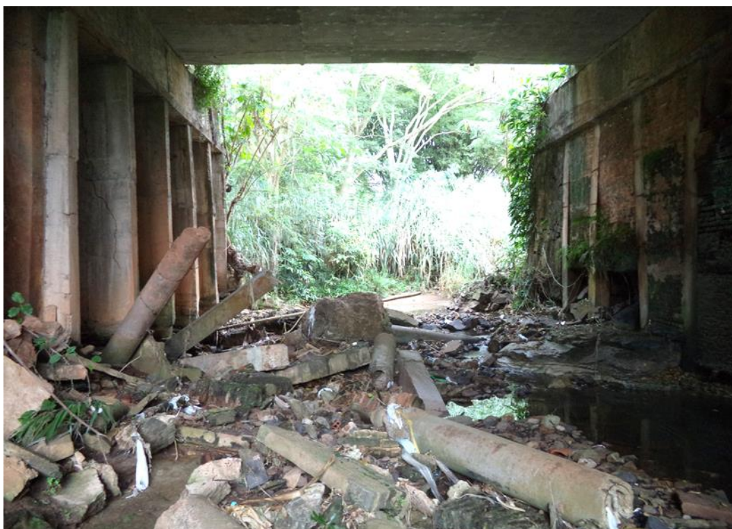
Imagem 59 – Presença de entulhos no Córrego Santa Rosa
