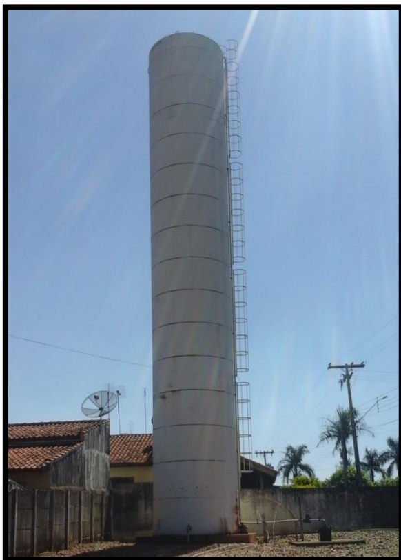
Imagem 20 – Reservatório João Pestana (R4)
