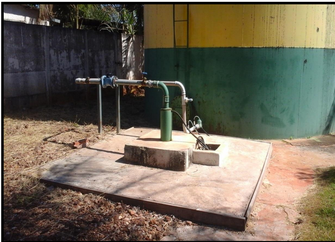
Imagem 9 – Poço Saída Catanduva (P6)
