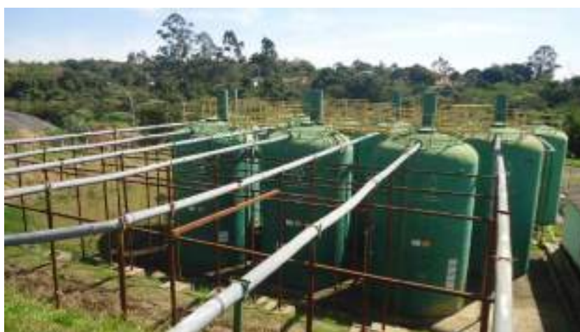
Figura 30 - Reatores Anaeróbios - ETE Cruzeiro do Sul.
