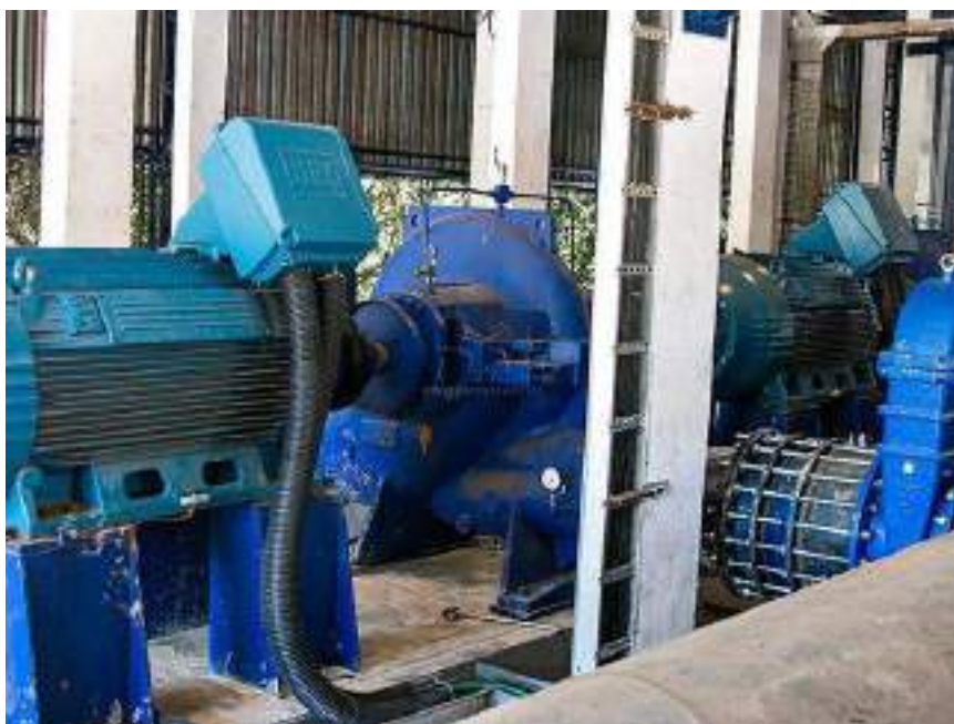
Figura 11 - Novos Equipamentos EEAB Santa Alice
