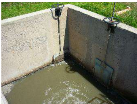
Figura 132 - Caixa Distribuidora de Vazão
