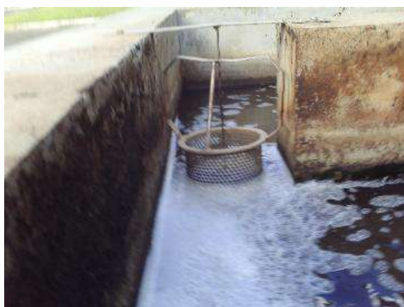
Figura 147 - Detalhe do Suporte de Cloro Pastilha
