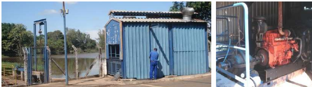
Figura 31 - Casa da Bomba Diesel (esq.) e Bomba Diesel (dir.)
