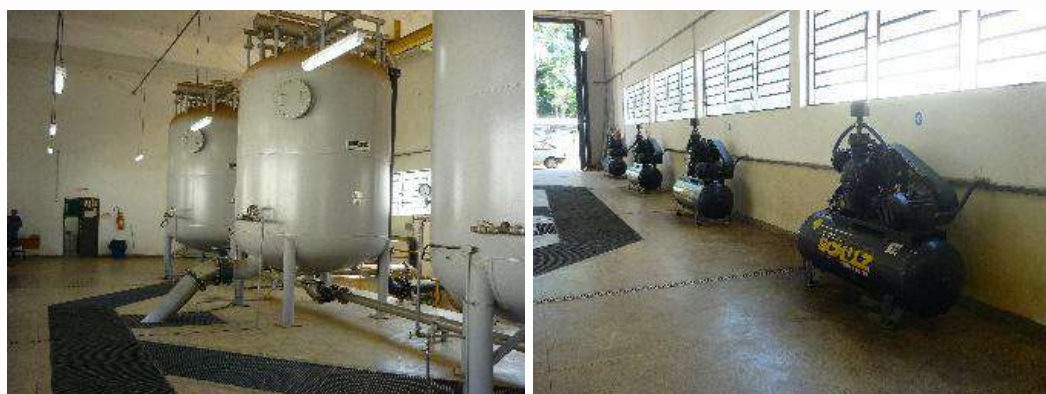
Figura 121 - Sala de Saturação Ar-Líquido (esq.) e Compressores para os Flotadores (dir.)
