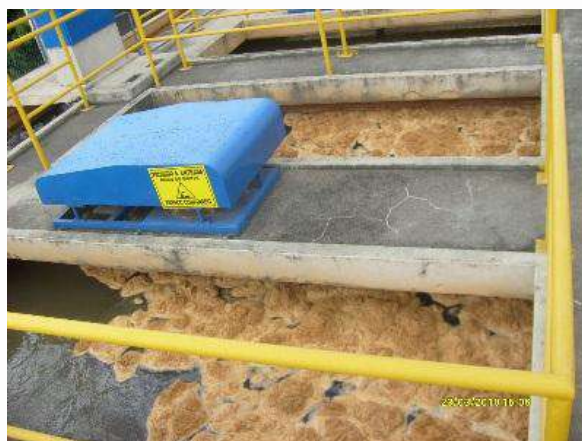
Figura 49 - Floculadores da Etapa 1
