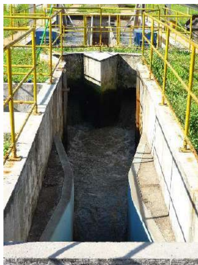
Figura 107 - Calha Parshall - Detalhe da Entrada
