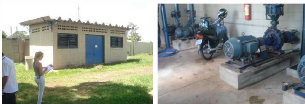
Figura 88 - Casa de bombas (esq.) e Conjuntos Moto-bomba (dir.)
