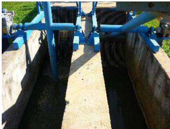
Figura 104 - Gradeamento com Limpeza Mecanizada
