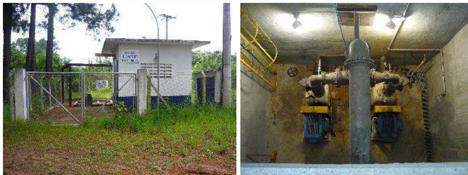
Figura 166 - Vista Frontal (esq.) e Vista Superior dos Conjuntos Moto Bomba (dir.)
