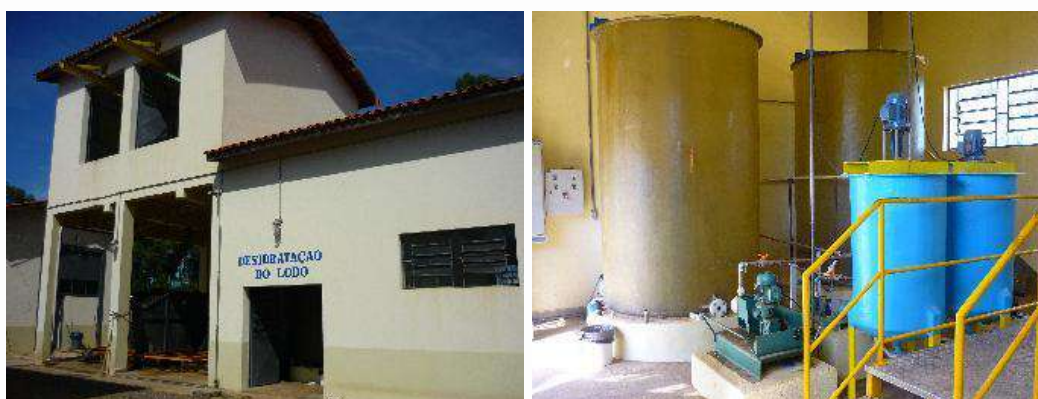
Figura 123 - Unidade de Tratamento do Lodo (esq.) e Sala de Preparo de Polímeros (dir.)
