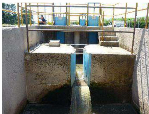
Figura 131 - Medidor de Vazão Parshall
