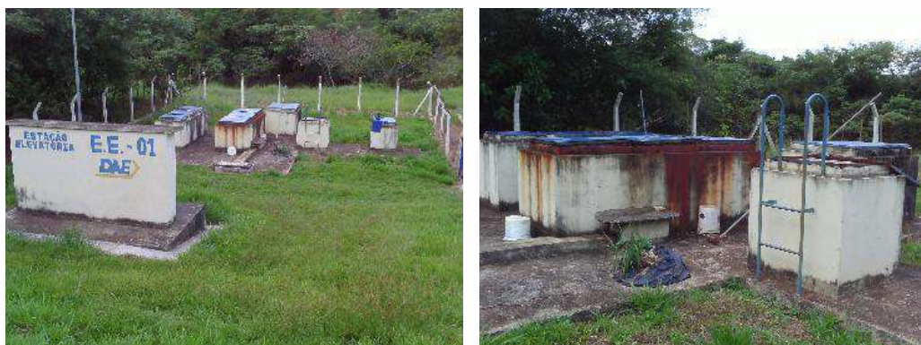
Figura 162 - Vista Geral (esq.) e Detalhe da Caixa de Chegada de Esgoto (dir.)
