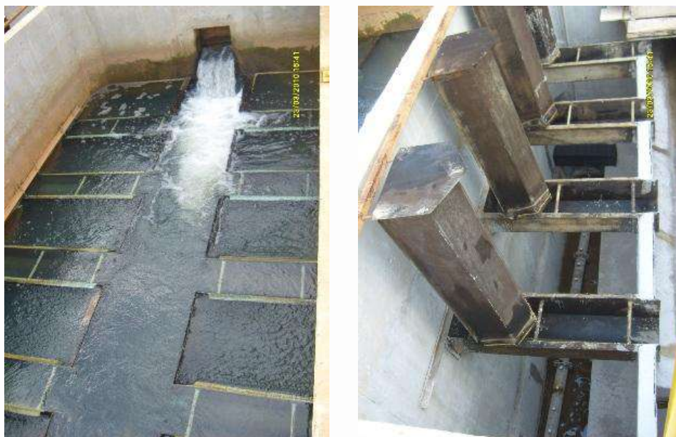
Figura 72 - Filtro em operação (esq.) e Filtro em manutenção (dir.)
