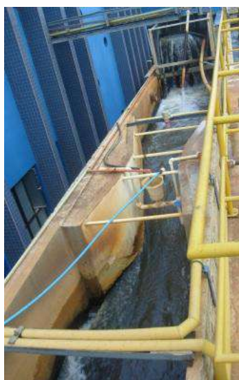
Figura 69 - Calha Parshall: Adição de Cal e Sulfato
