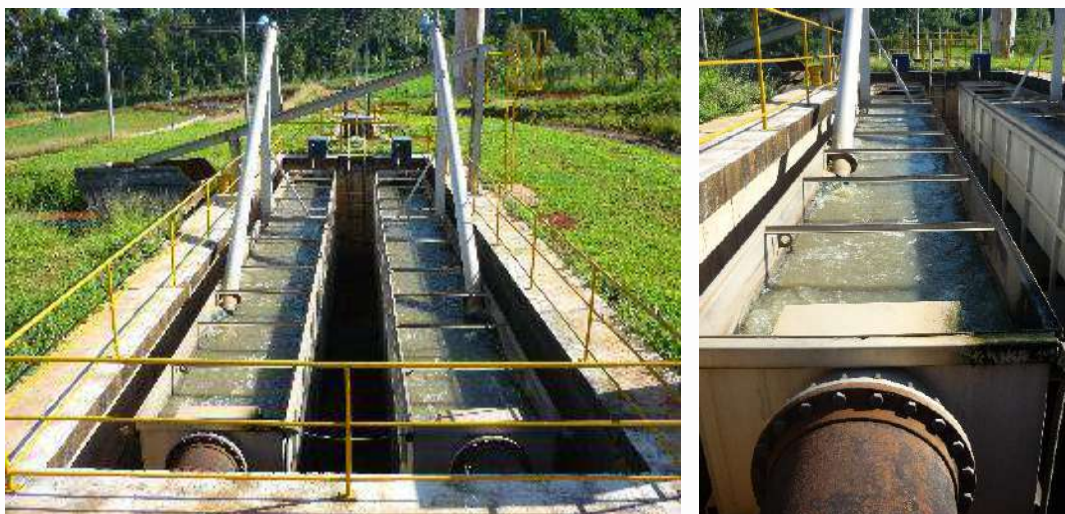
Figura 105 - Caixas de Areia (dir.) e Detalhe da Bomba Parafuso (esq.)
