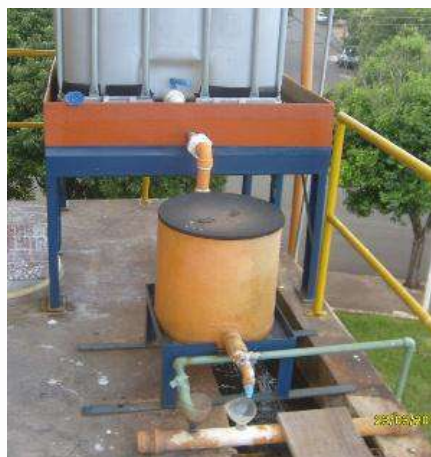
Figura 58 - Adição de Sulfato no Canal de Chegada
