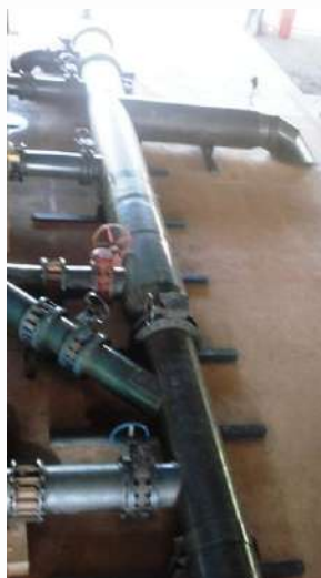
Figura 29 - Tubulações de Sucção (esq.) e Barrilete de Recalque da EEAB (dir.)
