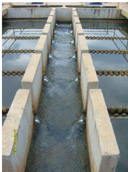
Figura 71 - Canal de Coleta de Água Decantada
