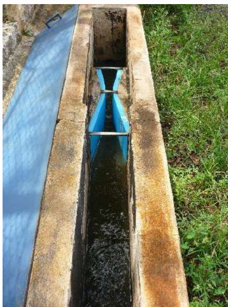
Figura 155 - Medidor Parshall de Esgoto Tratado
