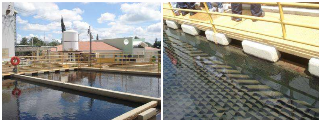
Figura 42 - Decantadores (esq.) e Detalhe de Módulos Plásticos e Vertedouro de saída (dir.)
