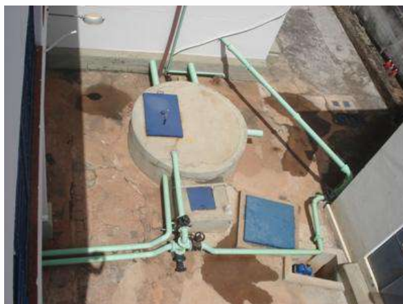
Figura 45 - Poço de Sucção
