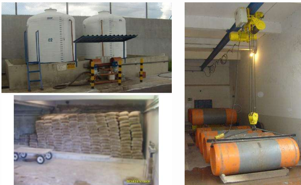
Figura 57 - Tanques de Sulfato e Flúor (acima), Depósito de Cal (abaixo) e Tanques de Cloro (dir.)
