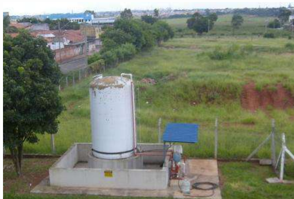
Figura 65 - Tanque de Sulfato de Alumínio
