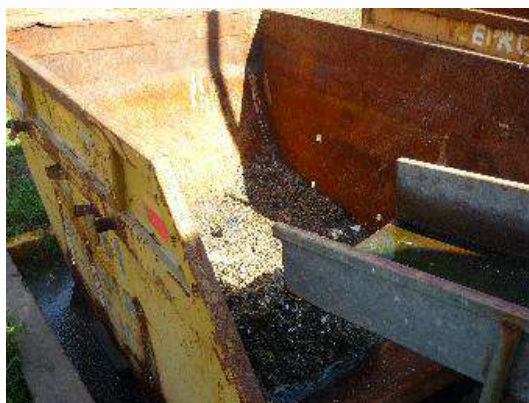
Figura 109 - Caçamba do Sistema de Peneiramento
