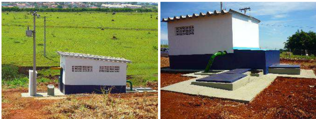
Figura 170 - Vista Geral da EEE (esq.) e Detalhe Tubulação de Recalque (dir.)
