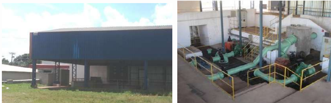
Figura 81 - Casa de bombas (esq.) e Conjuntos Moto-bomba (dir.)
