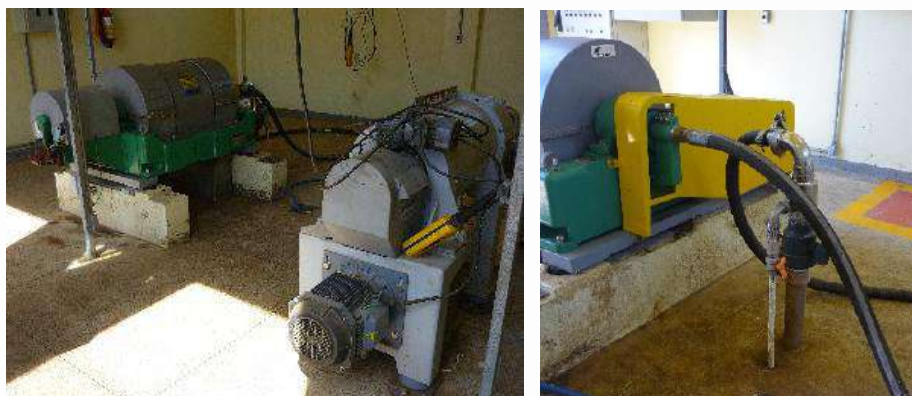
Figura 124 - Centrífugas (esq.) e Detalhe do Ponto de Aplicação de Polímero (dir.)
