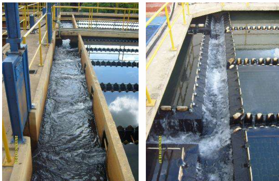
Figura 51 - Canal coletor de água decantada Etapa N°1 (esq.) e Etapa N°2 (dir.)
