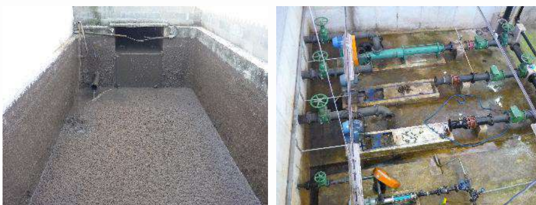
Figura 119 - Tanque de Lodo (esq.) e Bombas para Recirculação e Descarte do Lodo (dir.)
