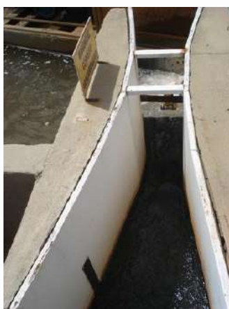
Figura 40 - Medidor de Vazão Parshall
