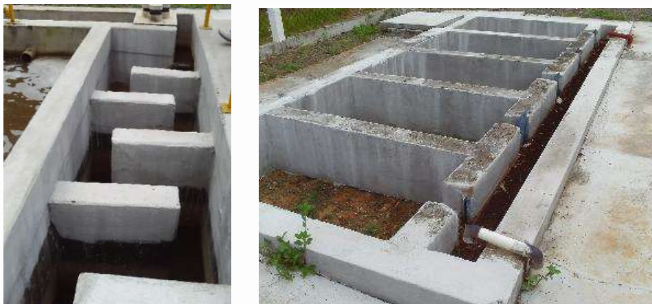
Figura 158 - Canal de Contato e Dispositivo de Cloração (esq.) e Leito de Secagem Desativado (dir.)
