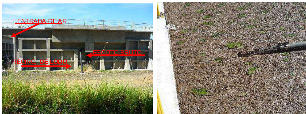
Figura 111 - Tanque de Aeração: Tubulações (dir.) e da Fixação do Sistema de Aeração (esq.)
