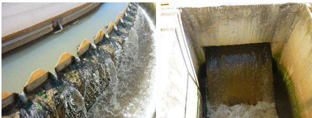
Figura 117 - Detalhe do Vertedor dos Flotadores (esq.) e Saída de Esgoto Tratado (dir.)
