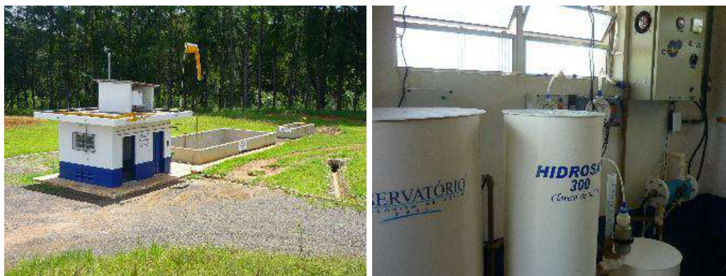
Figura 136 - Produção de Hipoclorito de Sódio - Vista Geral da Unidade (esq.) e Equipamentos (dir.)
