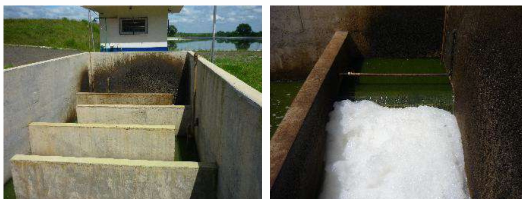
Figura 135 - Tanque de Contato - Vista das Chicanas (esq.) e Ponto de Dosagem de Cloro (dir.)
