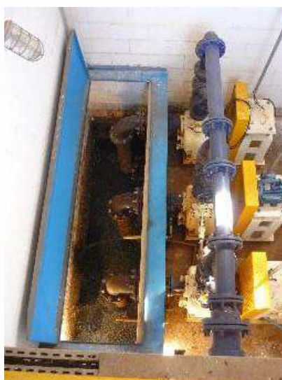
Figura 169 - Detalhe Conjuntos Moto Bombas e Poço de Sucção
