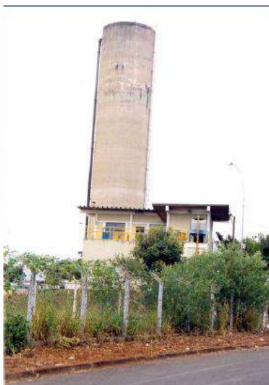
Figura 62 - Reservatório Elevado (Foto: Consorcio PCJ)
