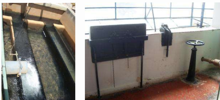
Figura 43 - Filtros (esq.) e Sala de Controle de Filtros (dir.)
