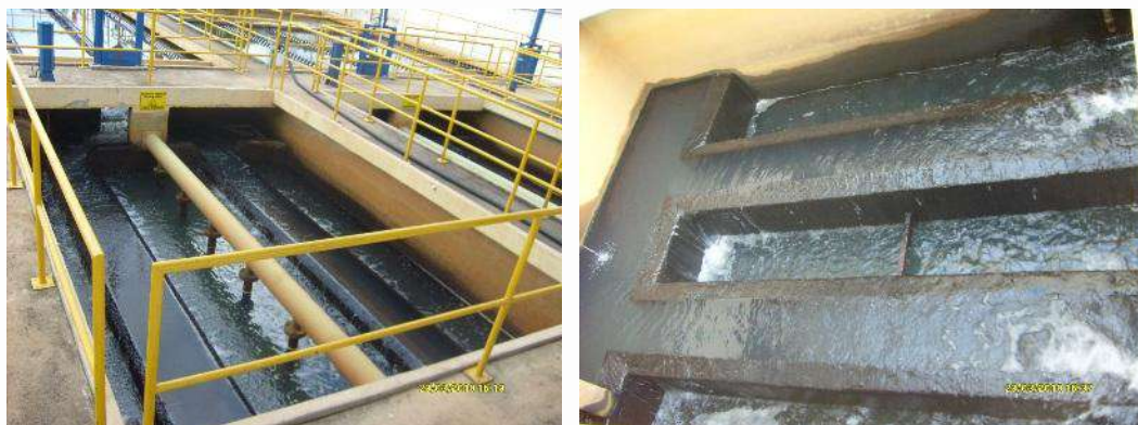
Figura 52 - Filtros de Etapa N°1 (esq.) e Etapa N°2 (dir.)
