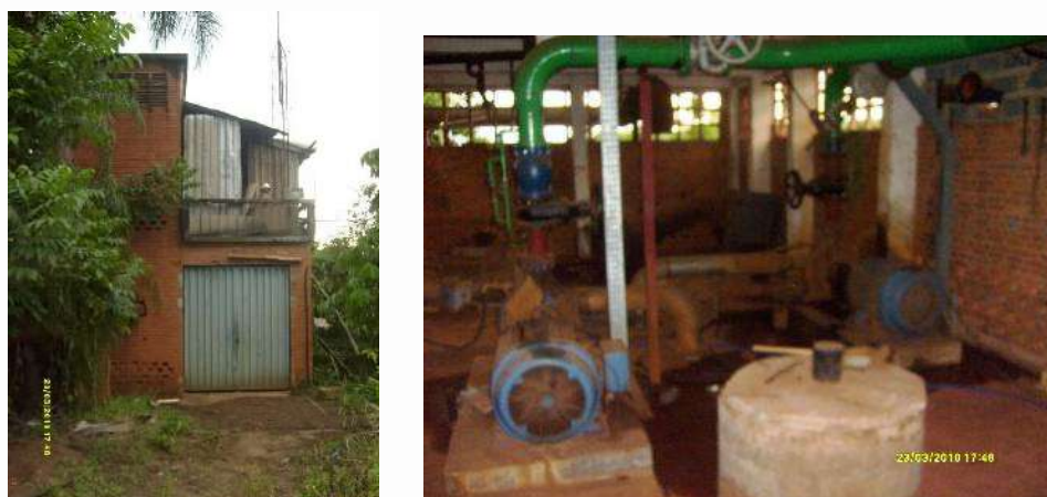
Figura 37 - Casa de Bombas EEAB Cillos
