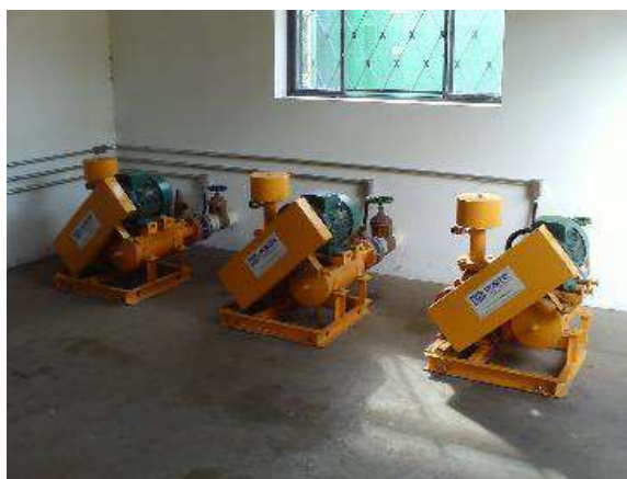
Figura 145 - Conjunto de Sopradores
