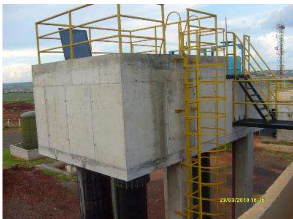
Figura 68 - Caixa Divisória de Vazão
