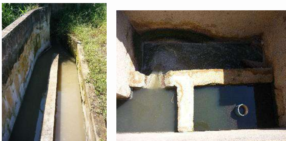
Figura 150 - Entrada de Esgoto Bruto: Caixa de Areia (esq.) e Saída dos Esgotos Tratados (dir.)
