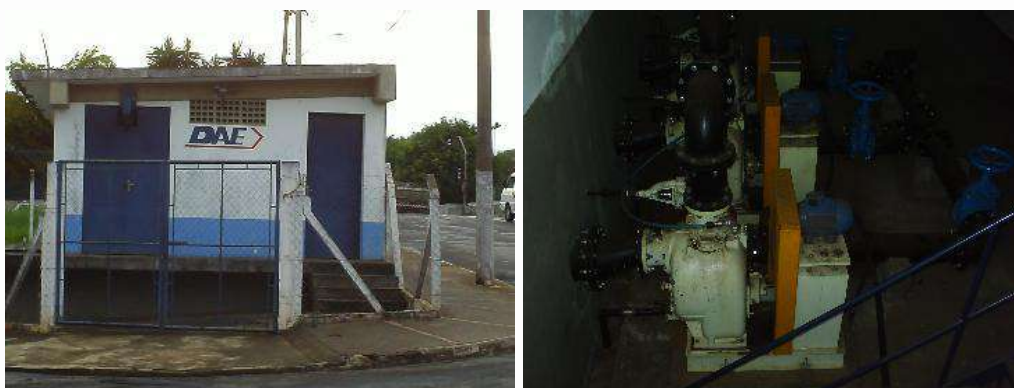
Figura 167 - Vista Frontal (esq.) e Detalhe dos Conjuntos Moto Bomba (dir.)
