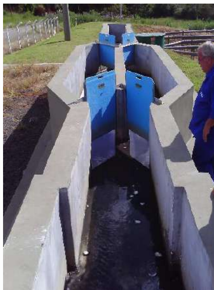
Figura 141 - Caixa de Areia
