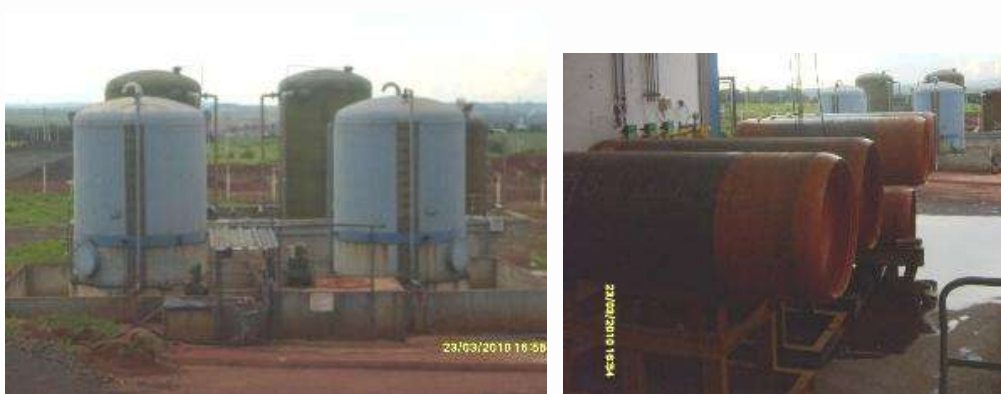
Figura 75 - Tanques de Produtos Químicos
