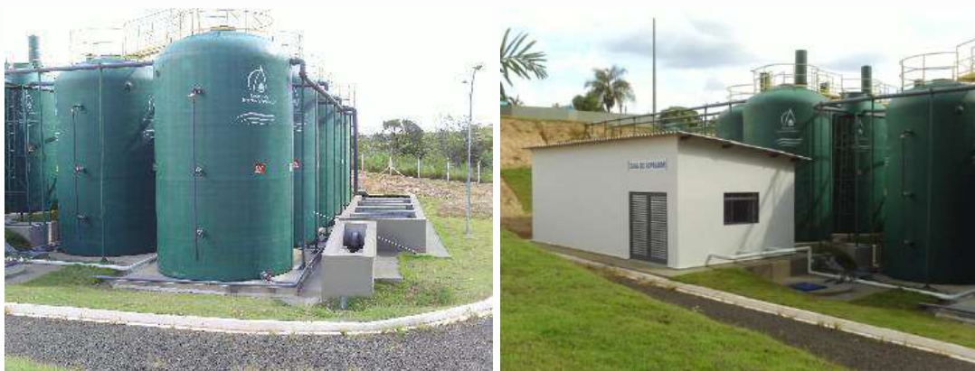
Figura 144 - Reatores Aeróbios (esq.) e Casa dos Sopradores (dir.)
