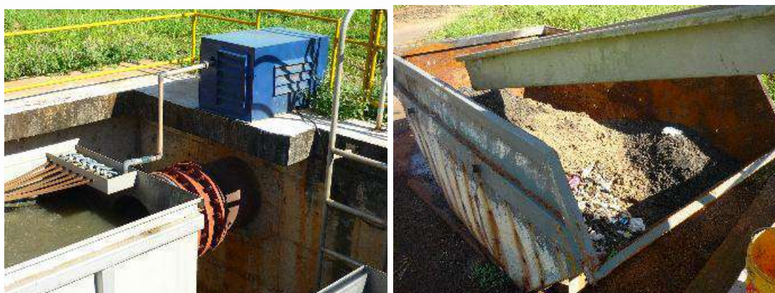
Figura 106 - Caixa de Areia - Detalhe Sistema de Injeção de Ar (dir.) e Caçamba com Areia (esq.)
