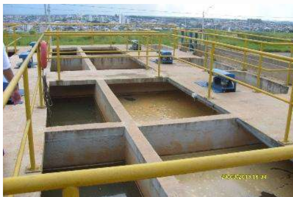
Figura 70 - Bateria de Flocladores Mecânicos
