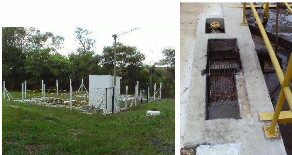
Figura 156 - Vista Geral da Estação (esq.) e Canal de Chegada de Esgoto Bruto: Gradeamento (dir.)
