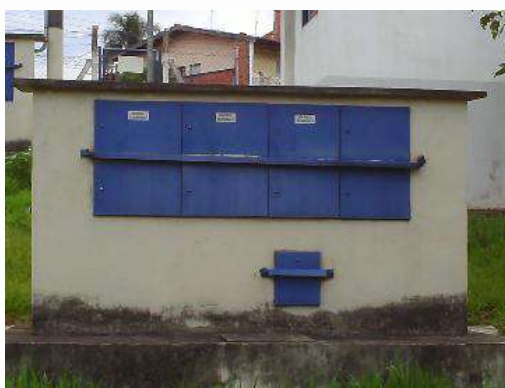
Figura 163 - Painel de Comando das Bombas
