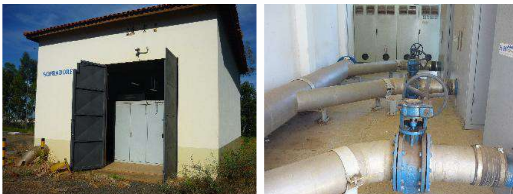
Figura 113 - Casa de Sopradores (dir.) e Tubulações (esq.)
