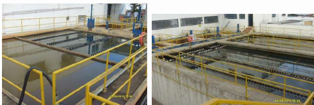
Figura 50 - Decantadores de Etapa N°1 (esq.) e Etapa N°2 (dir.)
