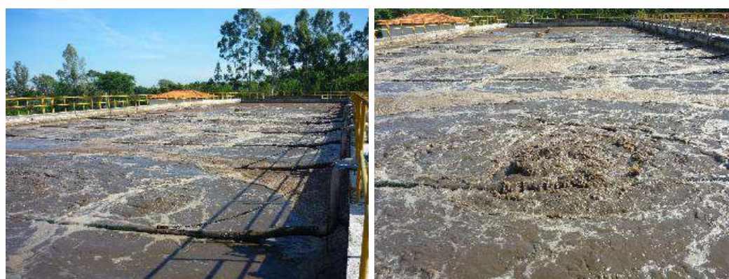
Figura 112 - Vista Superior e Detalhe do Sistema de Aeração dos Tanques de Aeração
