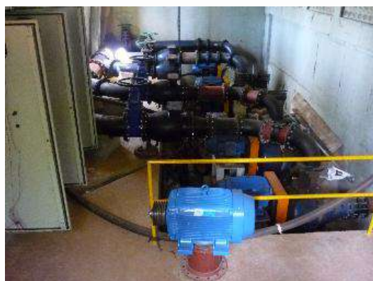
Figura 165 - Detalhe Posicionamento dos Conjuntos Moto Bomba
