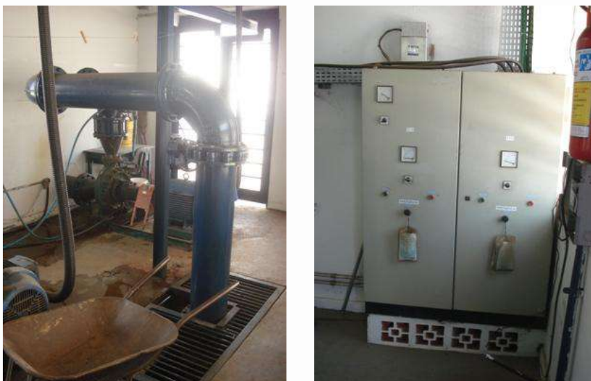
Figura 33 - Estação Elevatória EEAB-4
