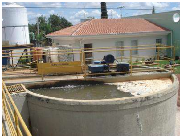
Figura 41 - Tanque Floculador Mecânico
