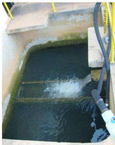
Figura 61 - Filtro em operação
