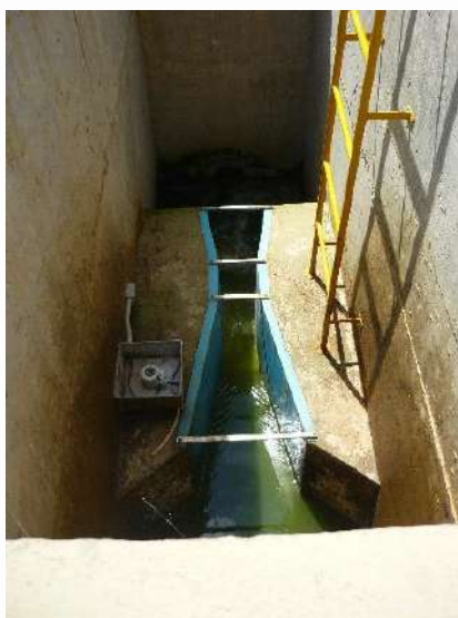
Figura 137 - Medidor de Vazão de Esgotos Tratados
