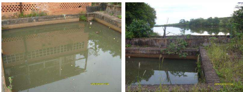
Figura 36 - Poço de Sucção
