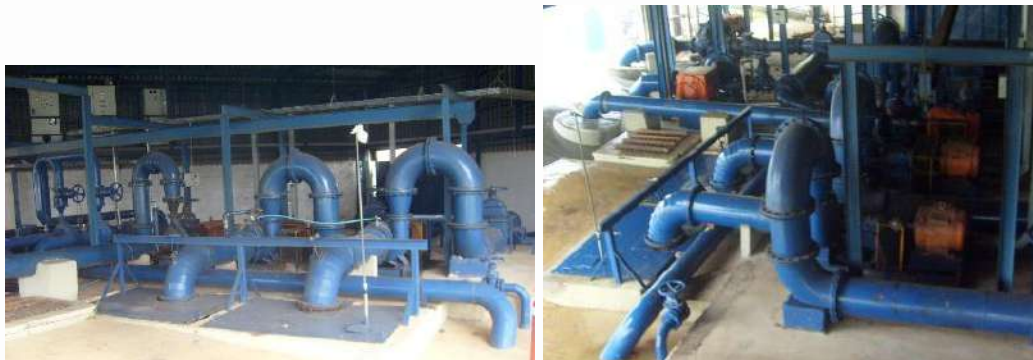
Figura 54 - Casa de Bombas
