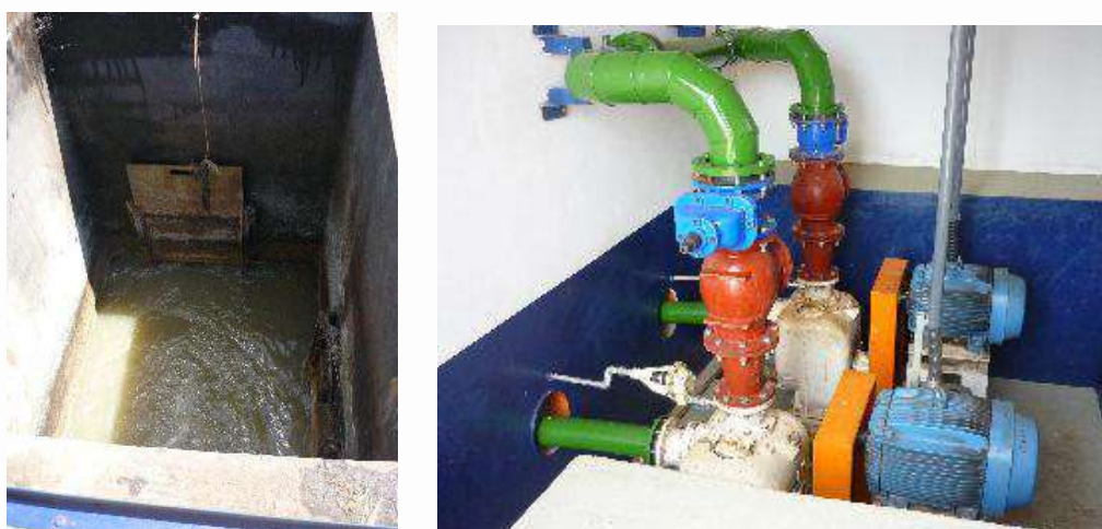
Figura 171 - Canal de Chegada de Esgotos (esq.) e Detalhe Conjuntos Moto Bomba (dir.)
