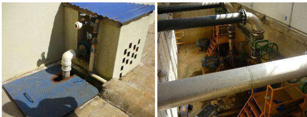
Figura 120 - Captação (esq.) e Bombas (dir.) de Esgoto Tratado para Saturação
