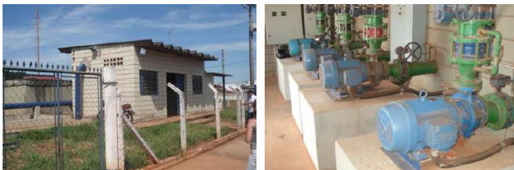
Figura 85 - Casa de Bombas (esq.) e Conjuntos moto-bomba (dir.)
