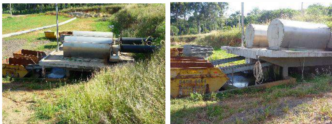
Figura 108 - Vista Lateral e Frontal do Sistema de Peneiramento
