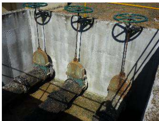
Figura 115 - Registro de Entrada de Esgoto nos Flotadores
