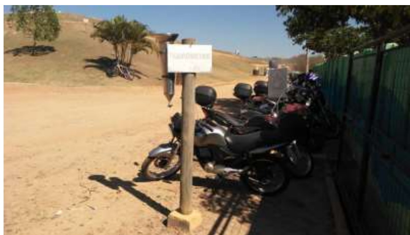
Figura 53 - Pluviômetro instalado no aterro. Fonte: CSO Ambiental, 2019.
