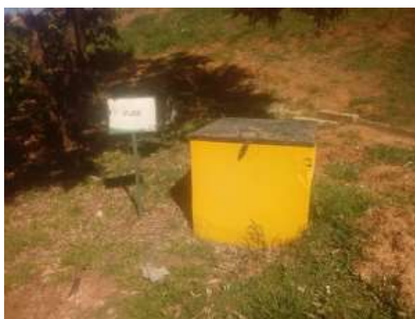
Figura 50- Reservatório de líquidos percolados nº 1. Fonte: CSO Ambiental
