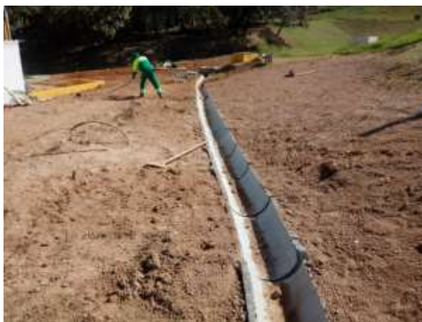
Figura 59- Canaletas de drenagem. Fonte: CSO Ambiental, 2019.
