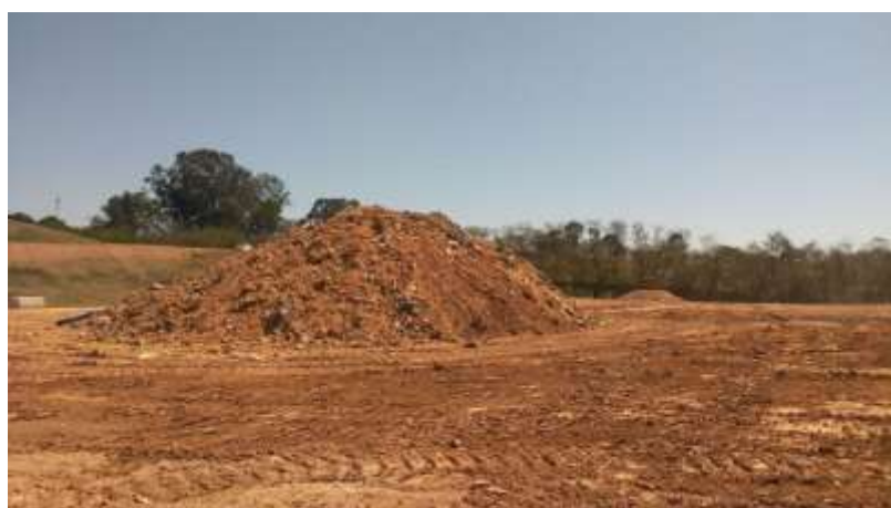
Figura 56- Depósito de terra para cobertura diária. Fonte: CSO Ambiental, 2019.
