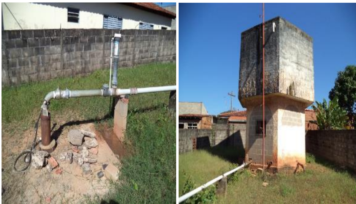
Figura 30. Poço 1 (P1) e Reservatório 1 (R1)
