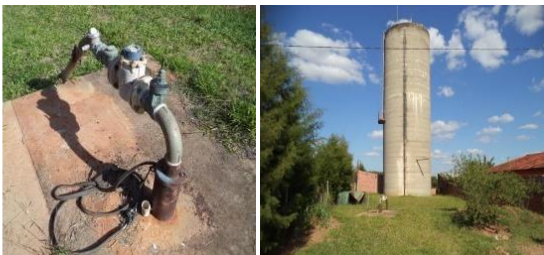
Figura 35. Poço 6 (P6) e Reservatório 6 (R6)
