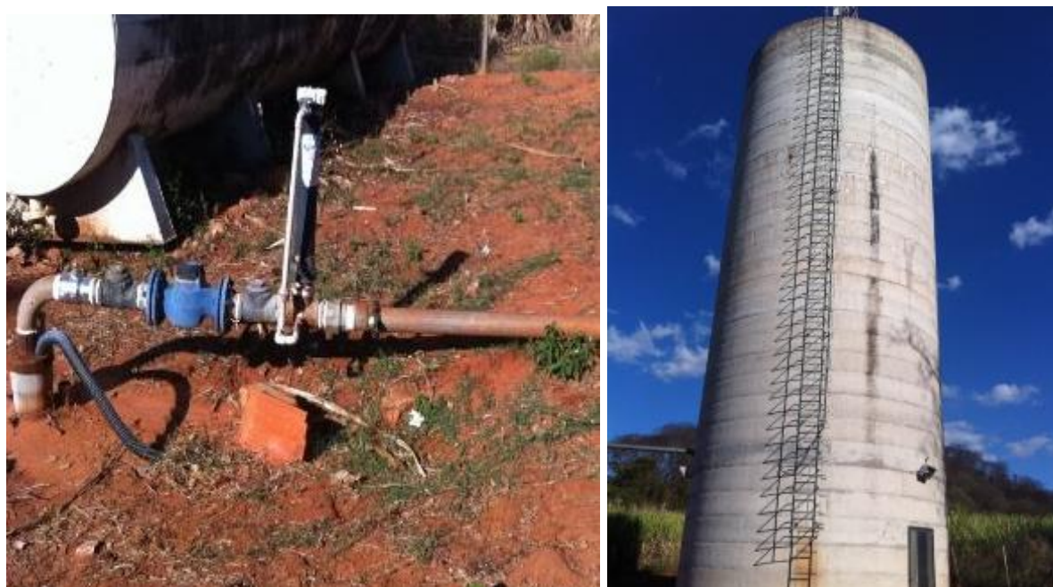
Figura 47. Poço 9 (P9) e Reservatório 10 (R10)
