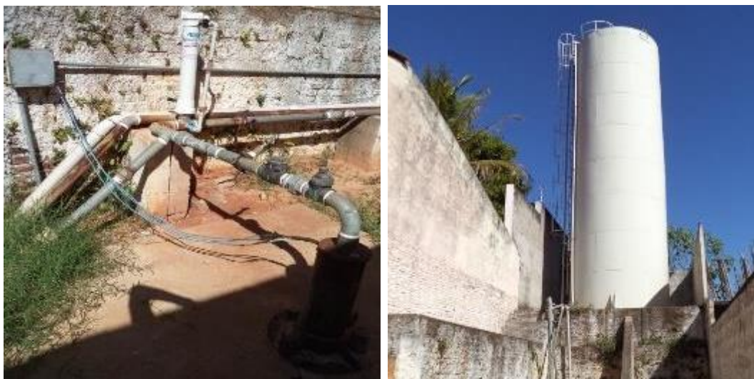
Figura 32. Poço 3 (P3) e Reservatório 3 (R3)
