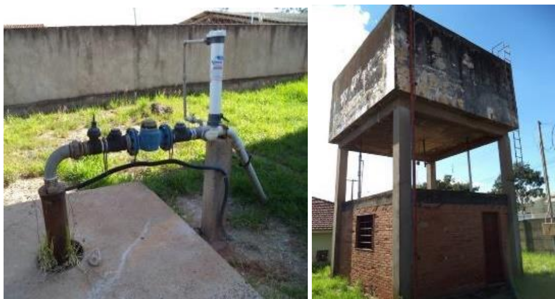
Figura 36. Poço 7 (P7) e Reservatório 7 (R7)
