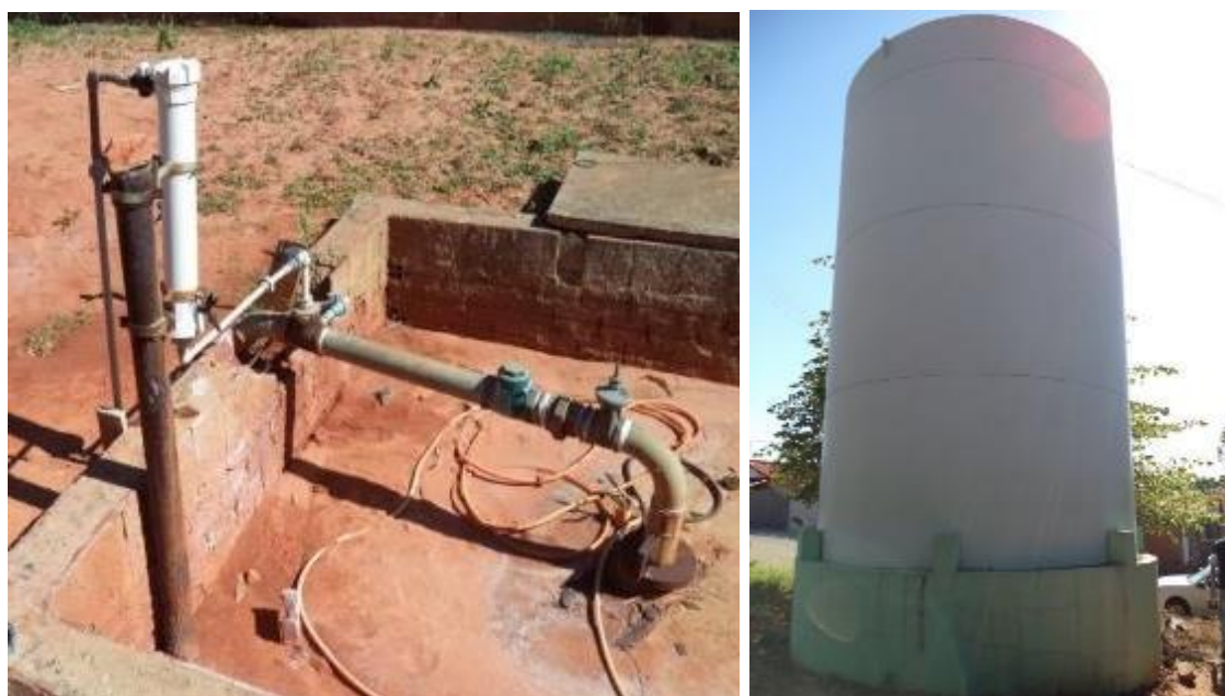
Figura 33. Poço 4 (P4) e Reservatório 4 (R4)
