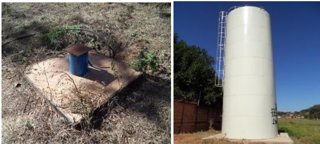
Figura 31. Poço 2 (P2) e Reservatório 2 (R2)
