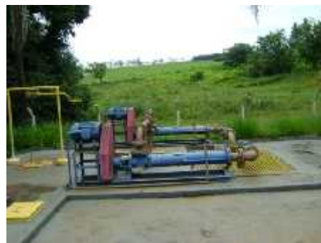
Figura 25- Estação elevatória de esgoto
