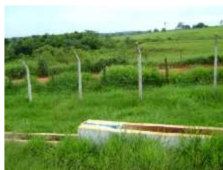
Figura 29- Calha Parshall da saída de efluentes da ETE
