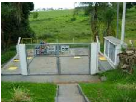
Figura 24- Estação elevatória de esgoto
