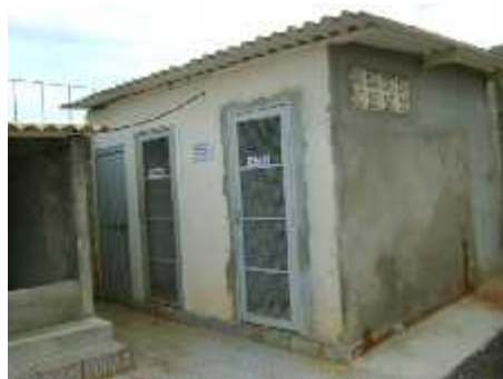
Figura 6 - detalhes do sistema de cloração e fluoreção
