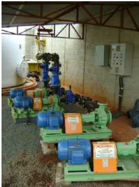
Figura 7- Conjunto de bombas da estação elevatória de água tratada
