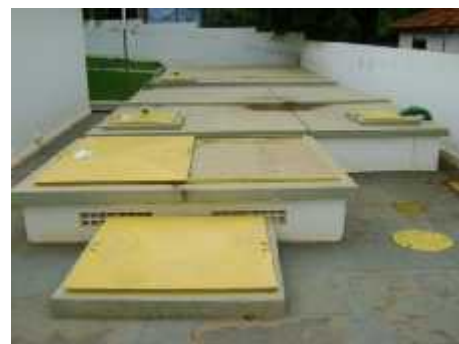
Figura 12- Estação Elevatória de Água Bruta (do poço 01)
