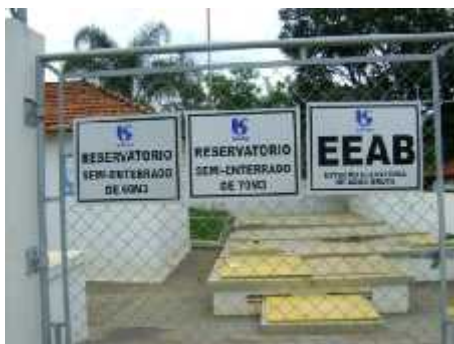
Figura 11- Estação Elevatória de Água Bruta (do poço 01)
