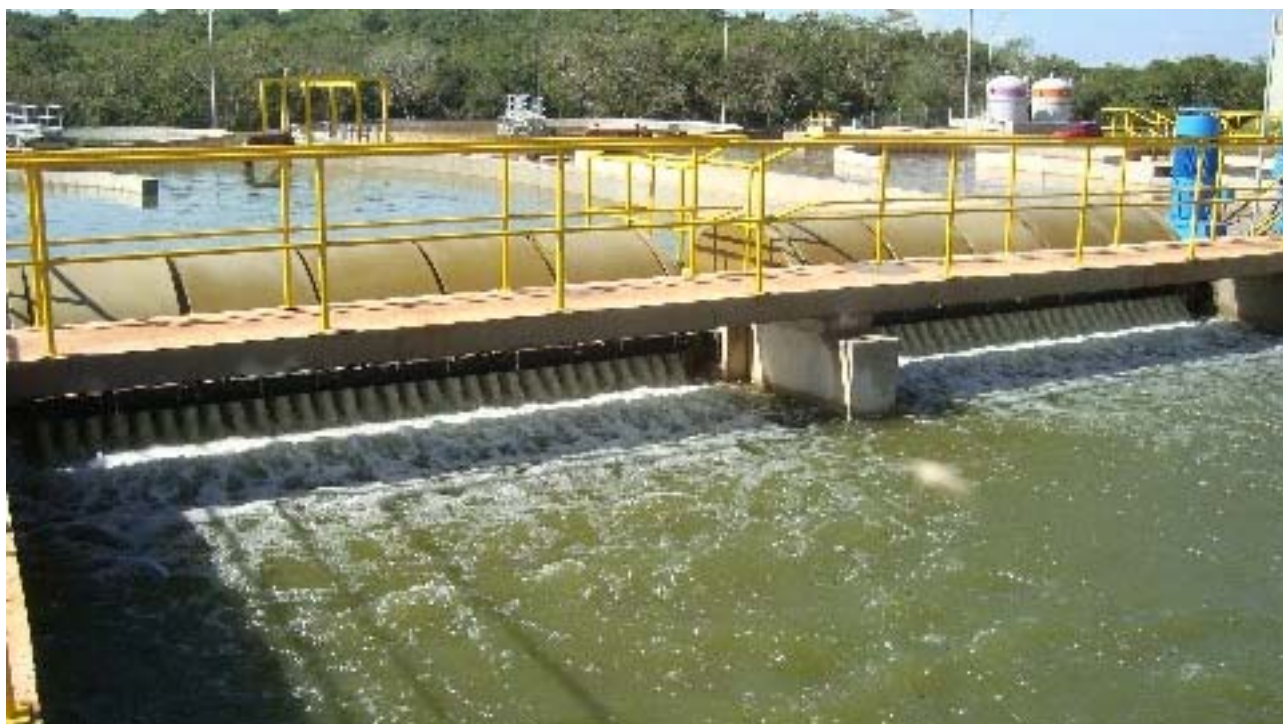
FIGURA 127. Vista das unidades de tratamento da ETE.
