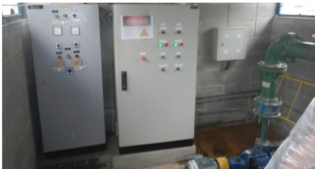
Vista interna das instalações da EEAT – CR-CECAP.
