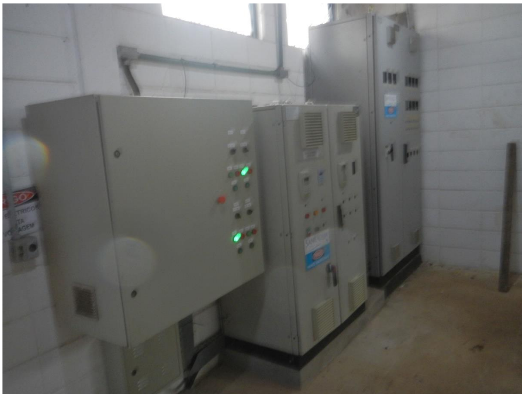
Vista interna das instalações da EEAT Waldez.
