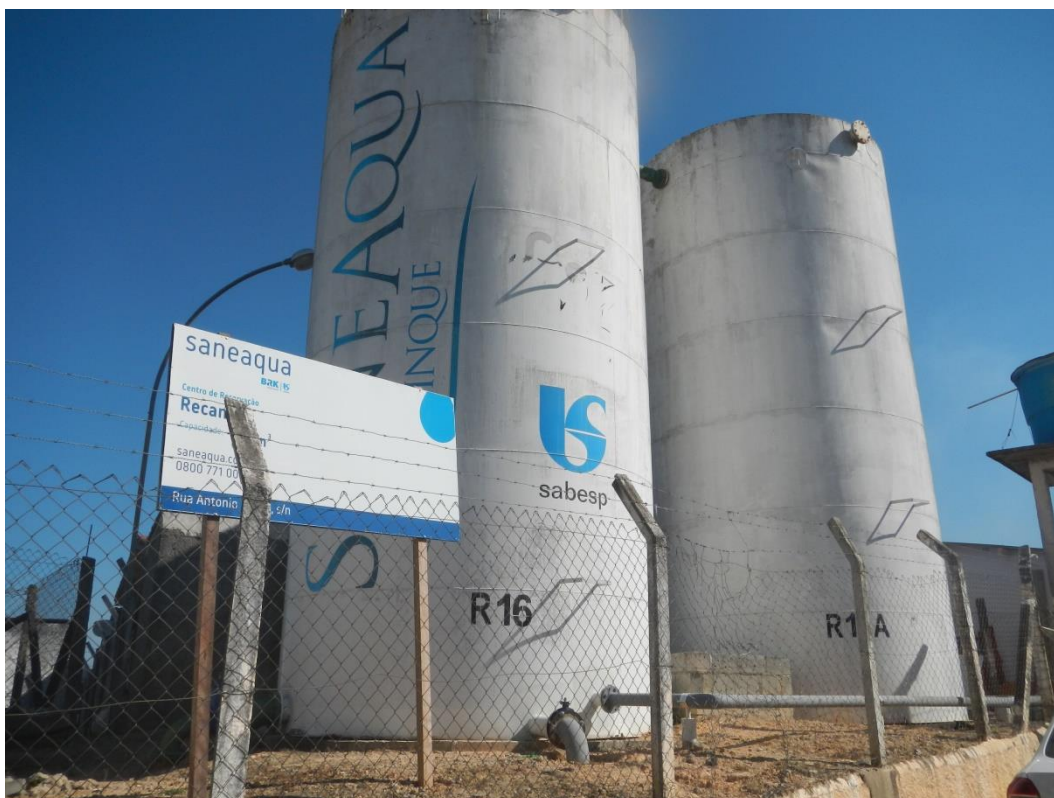
Vista dos reservatórios metálicos do CR Recanto.
