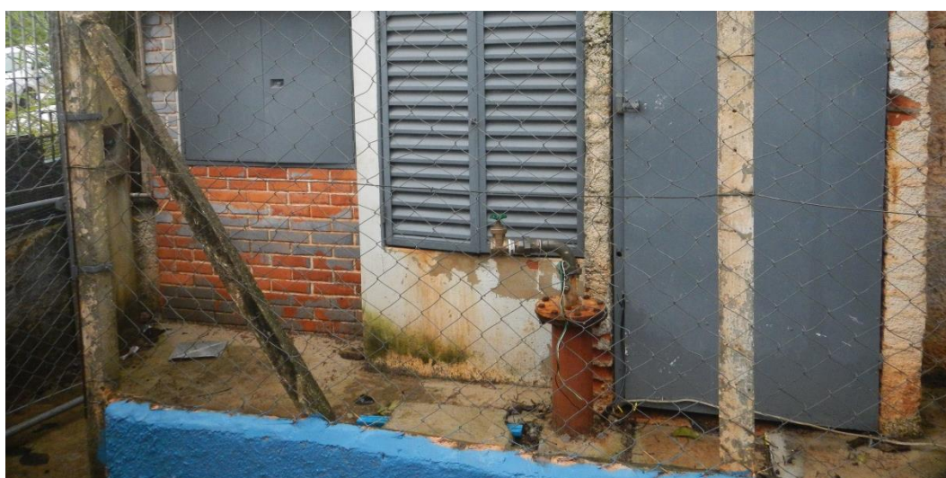
Vista das instalações do Poço P-17b.
