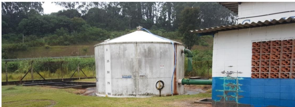
Vista do reservatório instalado na EEAT Ginásio.
