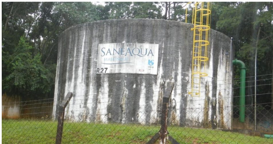
Vista de reservatório instalado na EEAT Waldez.
