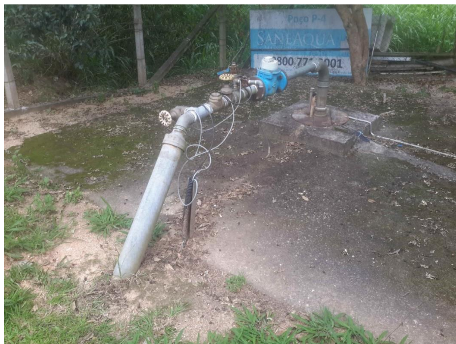
Vista das instalações do Poço P-4.
