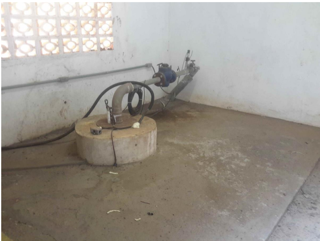
Vista das instalações do Poço P-5.
