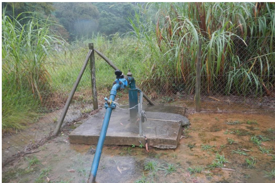
Vista das Instalações do Poço P-18.
