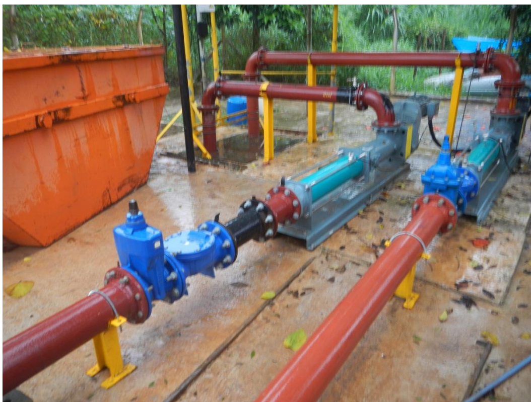
Vista das instalações da EEE Vitória.
