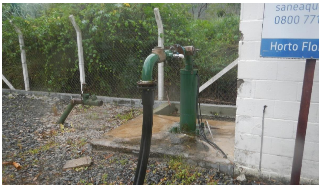
Vista das Instalações do Poço P-14.
