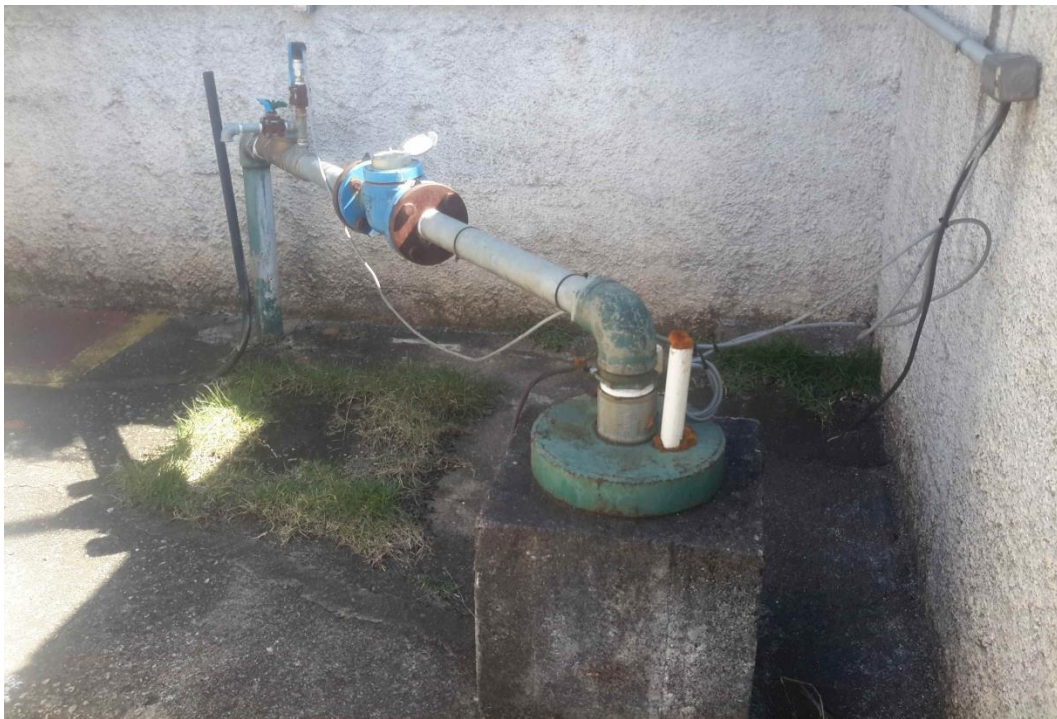
Vista das instalações do Poço P-9.
