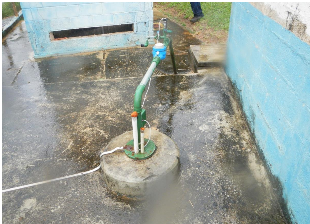
Vista das instalações do Poço P-11.
