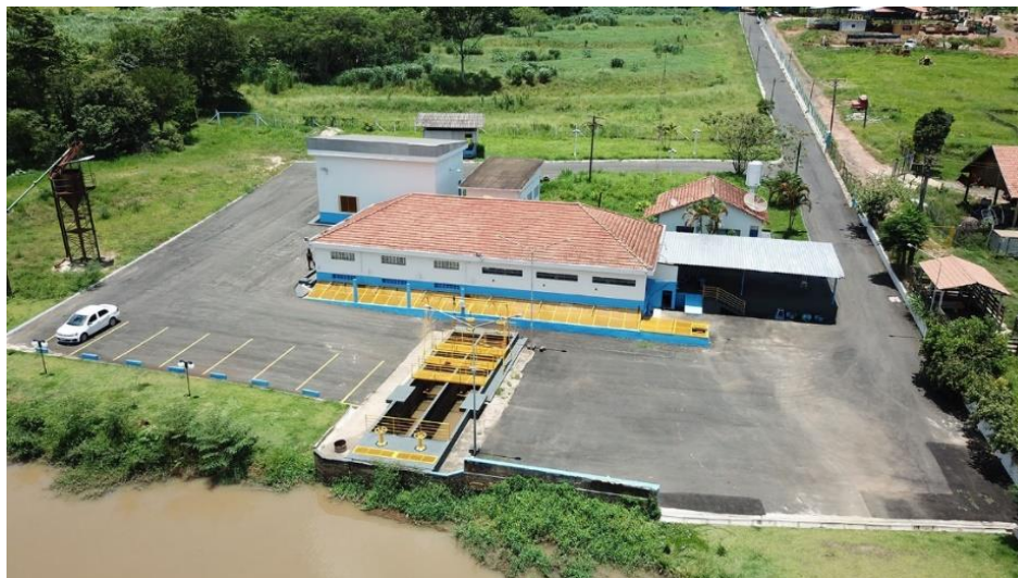
Figura 4. Captação de água superficial da SAECIL no ribeirão do Roque.
