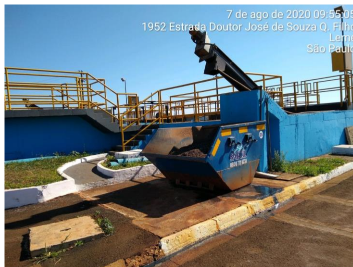
Figura 44. Caçamba de armazenamento temporário dos resíduos da caixa de areia da ETE da SAECIL.
