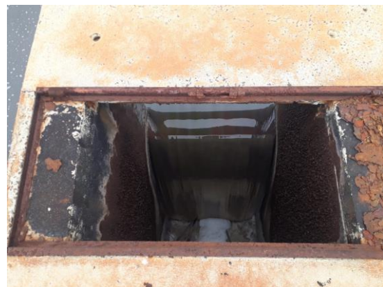
Figura 175 - Saída de efluente da Lagoa Facultativa
