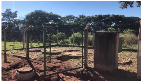
Figura 125 - Estação Elevatória de Esgoto - Morada do Campo
