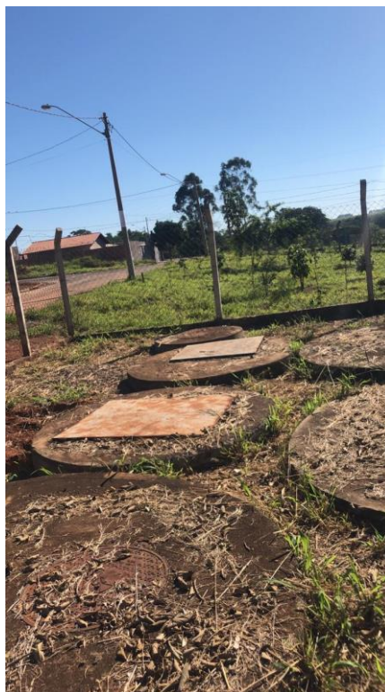
Figura 126 - Estação Elevatória de Esgoto - Morada do Campo
