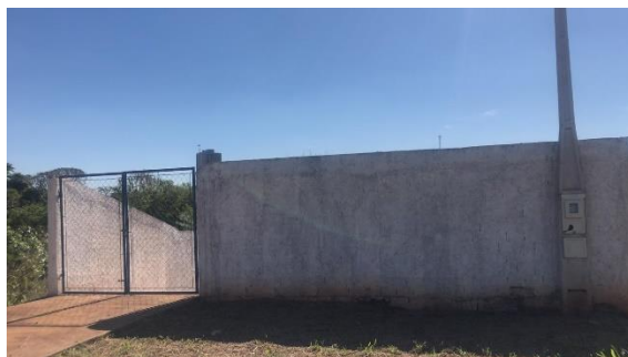
Figura 131 - Estação Elevatória de Esgoto – Athenas Paulista I
