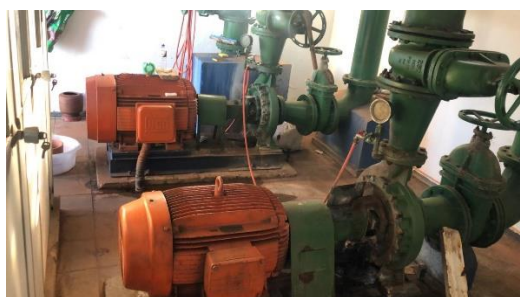
Figura 62 - Conjunto motor-bomba da EEAT da Rodoviária
