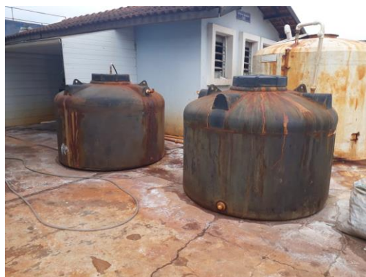
Figura 48 - Tanques de armazenamento de sulfato férrico inativos.
