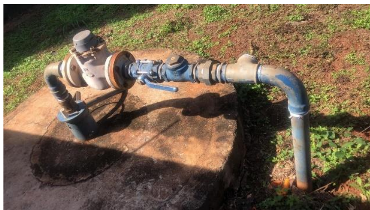
Figura 118 - Novo Poço Córrego Rico
