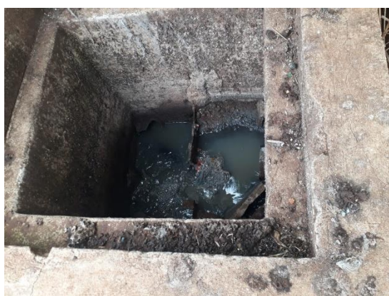
Figura 186 - Caixa de passagem de efluente
