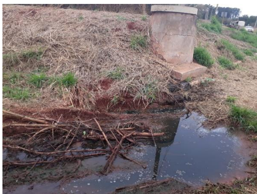
Figura 162 - Poço de Visita com vazamento de esgoto
