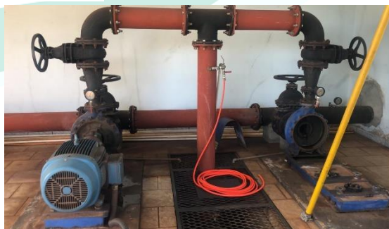
Figura 70 - Conjunto motor-bomba da EEAT Bairro Alto I
