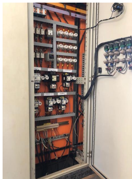
Figura 75 - EEAT ETA – interior Filtros
