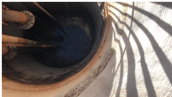
Figura 129 - Estação Elevatória de Esgoto – Distrito Industrial
