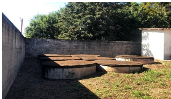
Figura 140 - Estação Elevatória de Esgoto – Estiva
