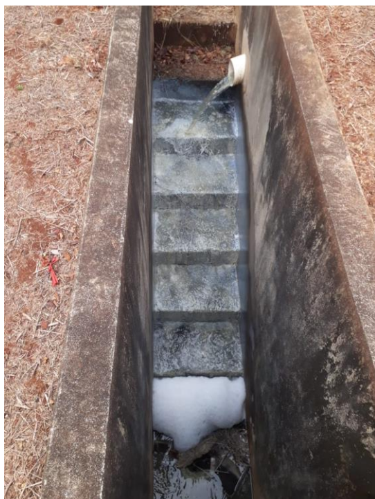
Figura 192 - Escada hidráulica de aerção
