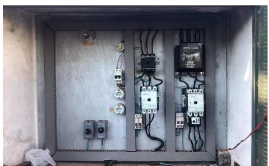
Figura 82 - Painel elétrico do booster COHAB II
