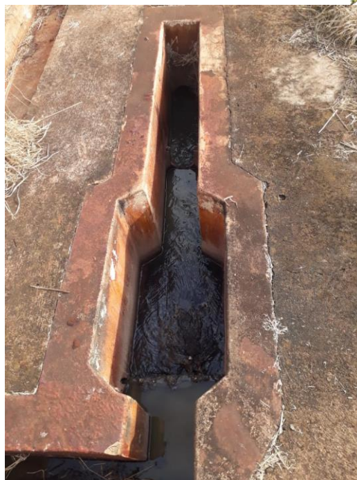
Figura 198 - Caixa de areia
