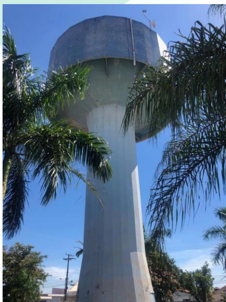
Figura 88 - Reservatório elevado utilizado para lavagem de filtros da ETA
