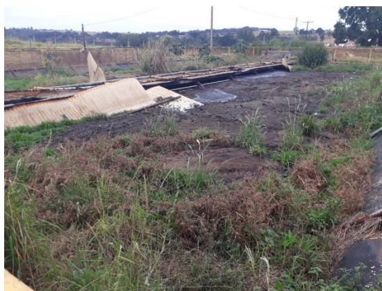
Figura 157 - DAFA saturado com vegetação, estrutura em ruínas
