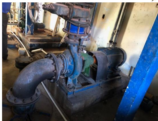
Figura 77 - EEAT ETA – Interior Filtros
