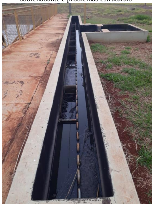
Figura 168 - Acúmulo de lodo e sedimento na canaleta de entrada dos DAFAs, obstrução das entradas de efluente
