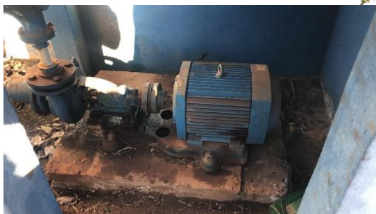
Figura 17 - Bomba apresentando falta de manutenção e vazamentos
