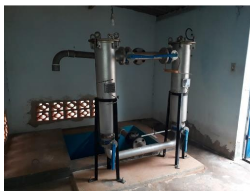
Figura 24 - Equipamento de filtração inoperante que foi instalado na área de desinfecção de Estiva
