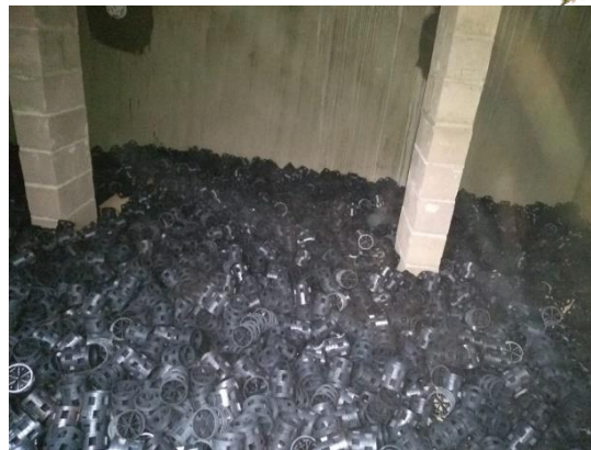
Figura 191 -Interior dos filtros de Biobobs Fonte: SAAEJ
