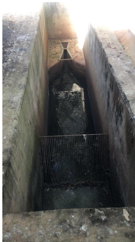
Figura 134 - Estação Elevatória de Esgoto – Athenas Paulista II
