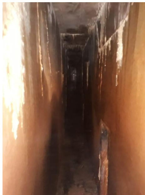
Figura 54 - Canal de escoamento da água de lavagem dos filtros com infiltração
