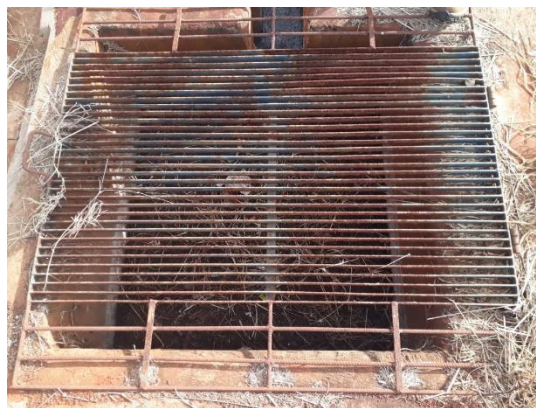
Figura 196 - Caixa de Passagem saturada de lodo
