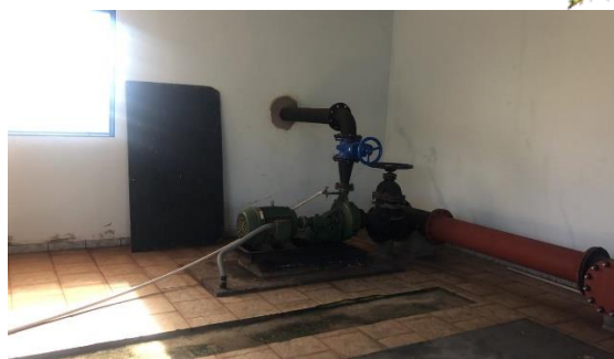
Figura 71 - Conjunto motor-bomba da EEAT Bairro Alto I
