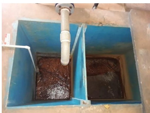
Figura 23 - Desinfecção da água dos drenos de Estiva.
