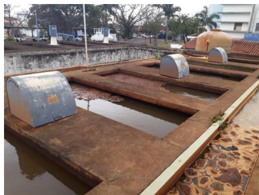
Figura 42 - Floculadores com Agitadores mecânicos
