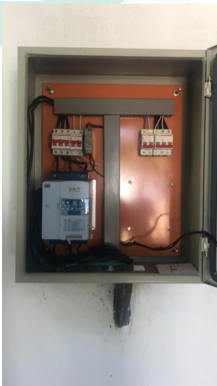
Figura 137 - Estação Elevatória de Esgoto – Jardim América
