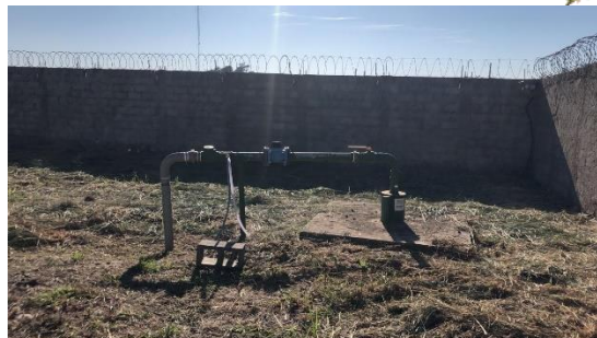
Figura 34- Poço Distrito Industrial
