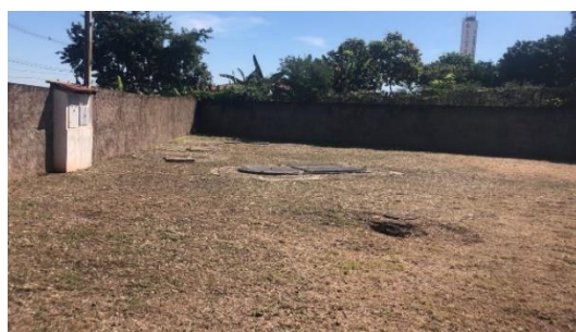
Figura 128 - Estação Elevatória de Esgoto – Distrito Industrial
