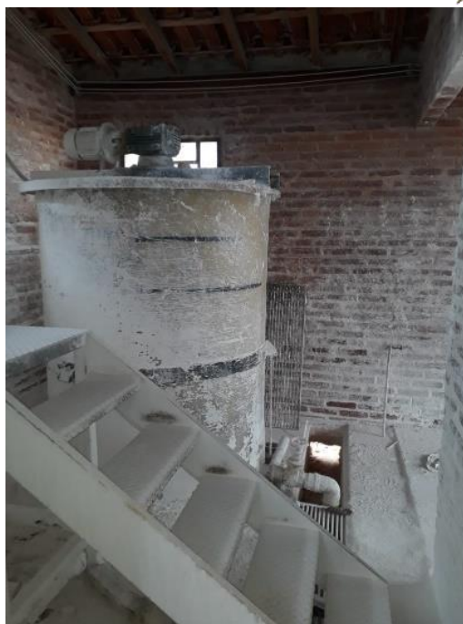
Figura 52 - Tanque de cal hidratada
