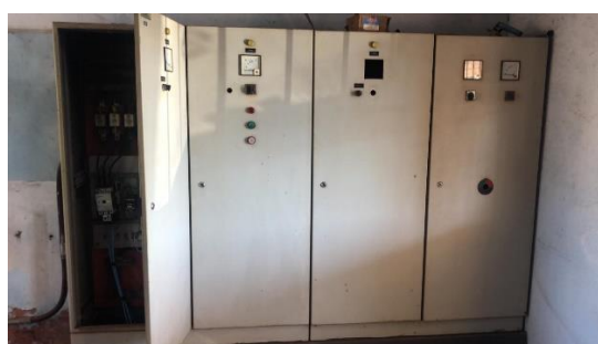
Figura 67- Painel elétrico da EEAT Bairro Alto II
