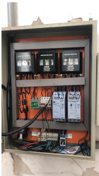
Figura 60- Pannel elétrico da EEAT COHAB I
