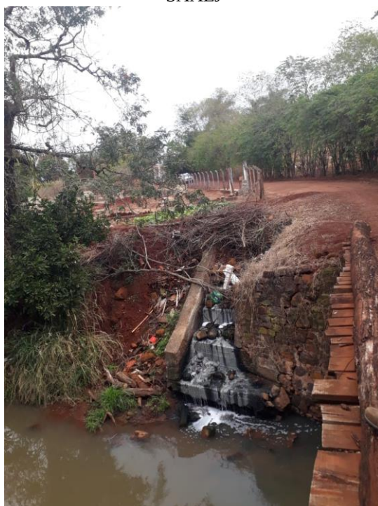
Figura 193 - Escada hidráulica de lançamento de efluentes com presença de entulho, resíduos de poda e resíduos domésticos.
