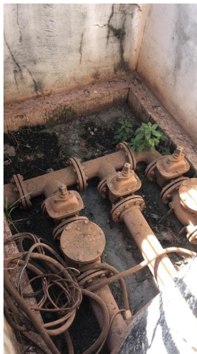
Figura 130 - Registros Estação Elevatória de Esgoto – Distrito Industrial
