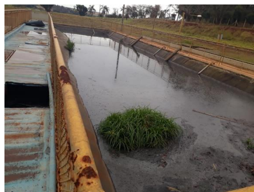
Figura 167 - DAFA com camada de sobrenadante, vegetação e estrutura oxidada e em ruínas
