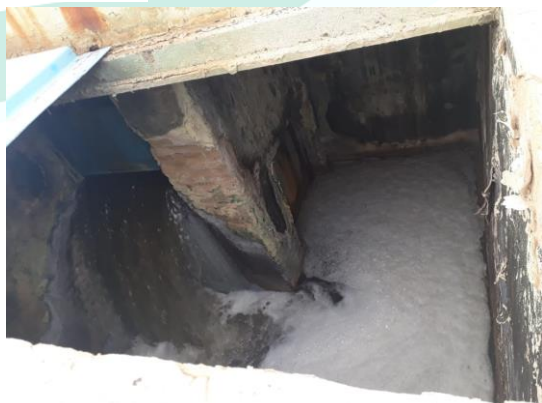
Figura 170 -Interior da caixa de passagem e distribuição de efluente dos DAFAs para as Lagoas Facultativas, formação de espuma
