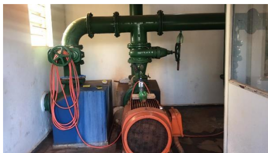
Figura 63 - Conjunto motor-bomba da EEAT da Rodoviária
