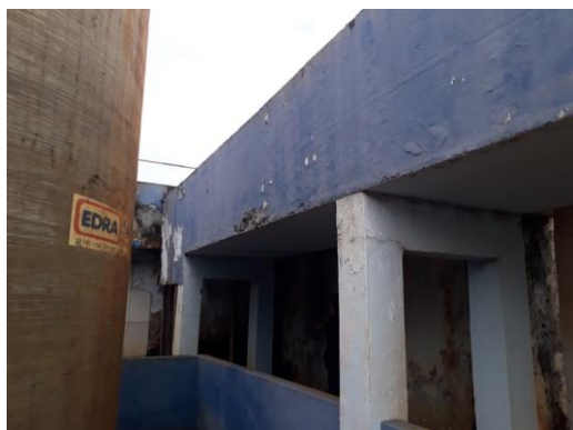
Figura 41 - Floculador inativo devido a estrutura que cedeu
