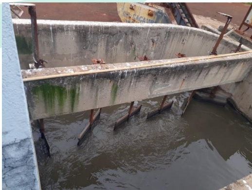
Figura 152 - Adensador de lodo superficial com corrosão no eixo das pás
