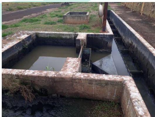
Figura 164 - Canaleta dos DAFAs com trincas, rachaduras e vazamento
