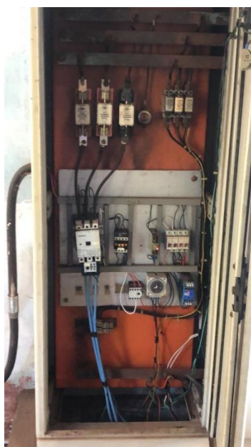
Figura 68 - Painel elétrico da EEAT Bairro Alto II
