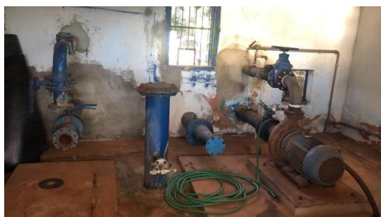
Figura 66 - Conjunto moto-bomba da EEAT Bairro Alto II
