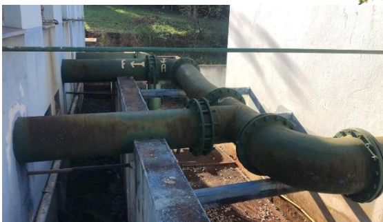
Figura 11 - Tubulações EEAB – Córrego Rico
