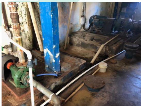
Figura 76 - EEAT ETA – Interior Filtros
