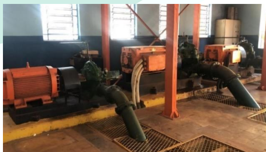
Figura 10 - Conjunto Moto-Bomba – Córrego Rico
