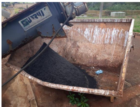
Figura 155 - Caçamba de descarte de lodo do adensador
