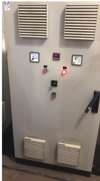
Figura 65- Caixa do painel elétrico da EEAT da Rodoviária
