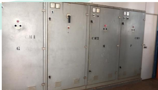
Figura 16 - Painéis Elétricos dos conjuntos motor-bomba
