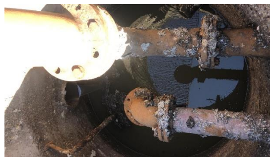
Figura 144 - Estação Elevatória de Esgoto – Estiva
