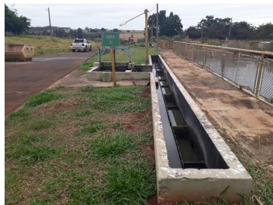
Figura 163 - Canaleta dos DAFAs com entradas de efluente parcialmente obstruídas
