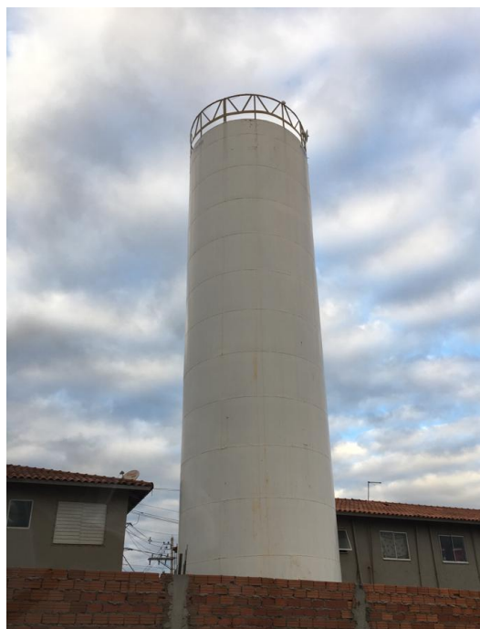
Figura 113 - Reservatório apoiado loteamento Vida Nova I
