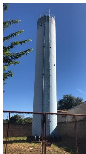
Figura 91 - Reservatório elevado Jd. Bom Jesus
