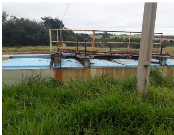
Figura 169 - Caixa de Passagem e distribuição de efluente dos DAFAs para Lagoas Facultativas e sistema de by pass para o Córrego Jaboticabal
