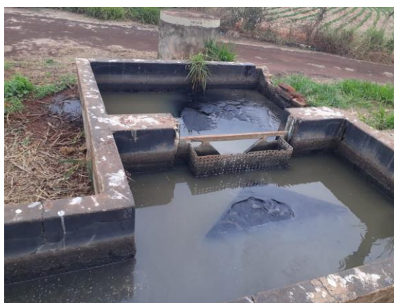
Figura 161 - Acúmulo de lodo e sedimentos no gradeamento e canaleta do DAFA
