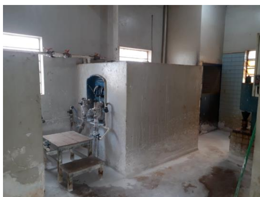
Figura 47 - Misturador de produto químico
