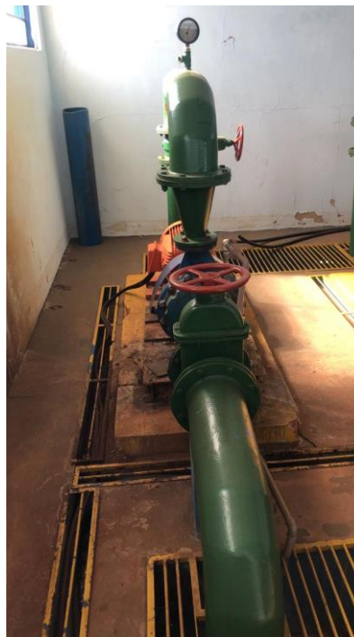
Figura 85 - Tubulação do Booster da Mascagni
