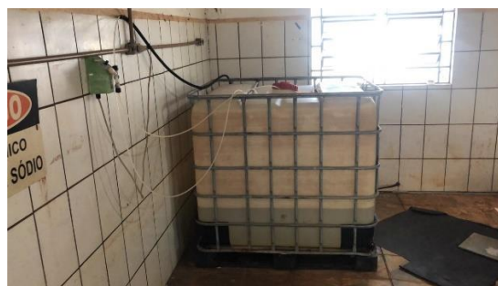
Figura 32 - Dosagem de Hipoclorito de Sódio para o Poço de Estiva II
