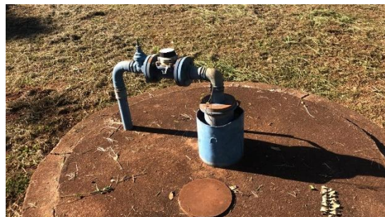
Figura 28 - Poço COHAB III com espaço anular sem vedação
