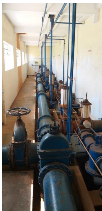
Figura 43 - Saída dos filtros
