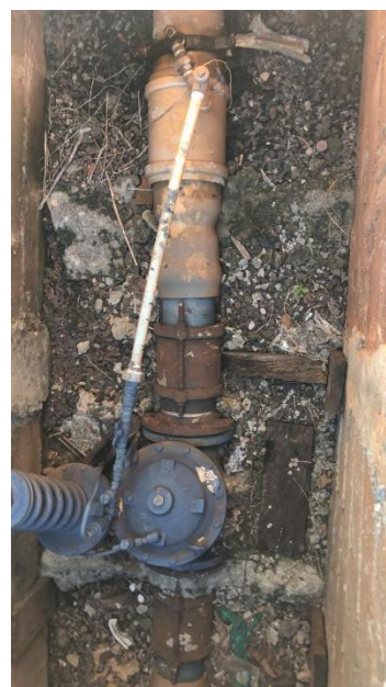
Figura 69 - Tubulação deteriorada da EEAT Bairro Alto II
