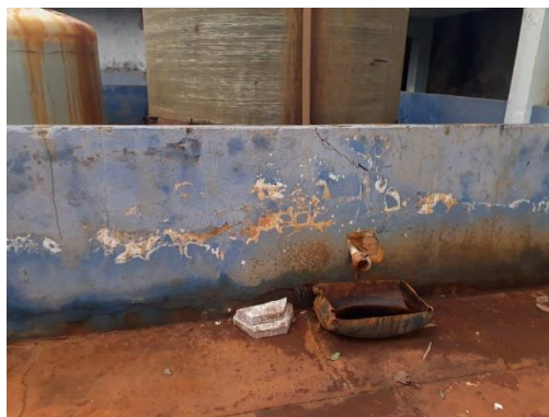
Figura 50 - Saída do tanque em utilização de cloreto férrico
