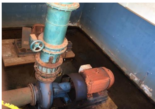
Figura 12 - Conjunto Moto-Bomba – Córrego Rico
