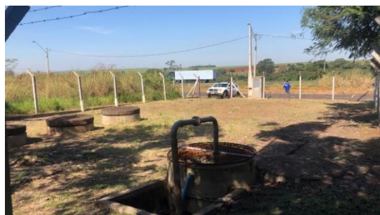
Figura 136 - Estação Elevatória de Esgoto – Jardim América
