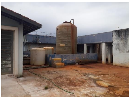
Figura 49 - Tanque em utilização de cloreto férrico
