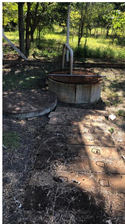
Figura 138 - Estação Elevatória de Esgoto – Jardim América
