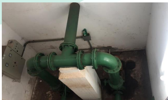
Figura 58 - Tubulações da EEAT COHAB 1 apresentando vazamentos
