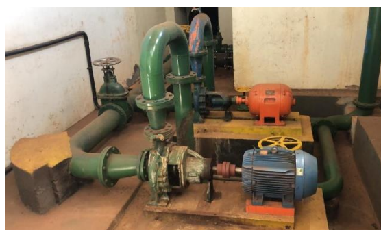
Figura 73 - Conjunto Motor-Bomba EEAT – Bomba do Buraco
