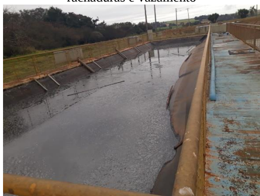
Figura 166 - DAFA com camada de sobrenadante e problemas estruturais
