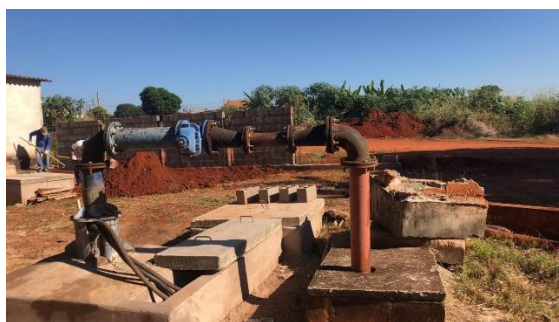
Figura 29 - Poço Bairro Alto
