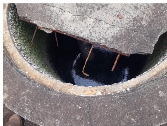
Figura 188 - Tampa da fossa séptica rompida
