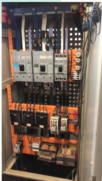
Figura 64 - Painel elétrico da EEAT da Rodoviária
