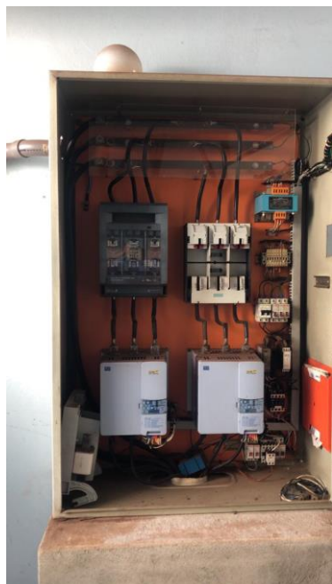
Figura 72 - Painel Elétrico da EEAT Bairro Alto I
