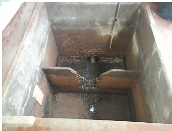
Figura 25- Dreno de Bairro Alto com as paredes corroídas devido ao pH ácido
