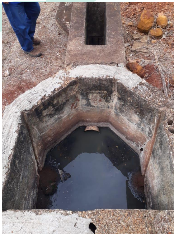
Figura 184 - Caixa de passagem de esgoto bruto
