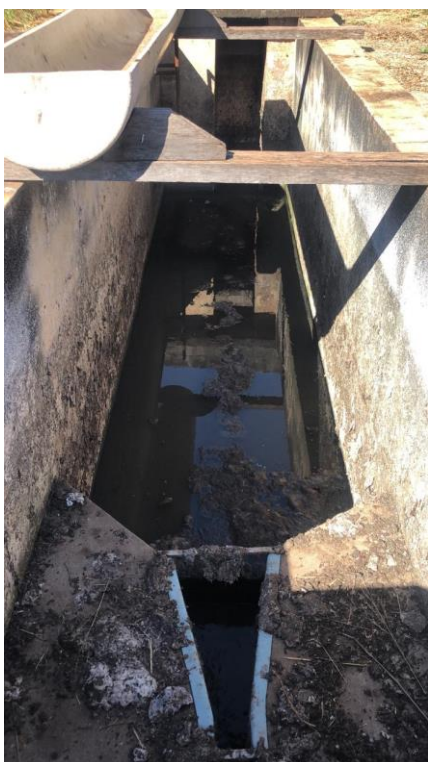
Figura 143 - Estação Elevatória de Esgoto – Estiva
