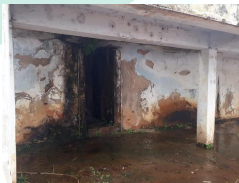
Figura 45 - Vazamentos aparentes na estrutura dos decantadores
