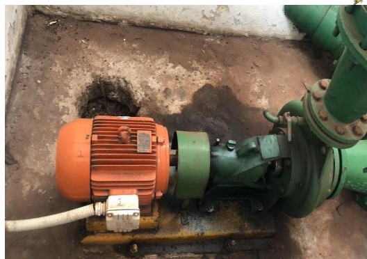
Figura 59 - Conjunto motor-bomba da EEAT COHAB 1
