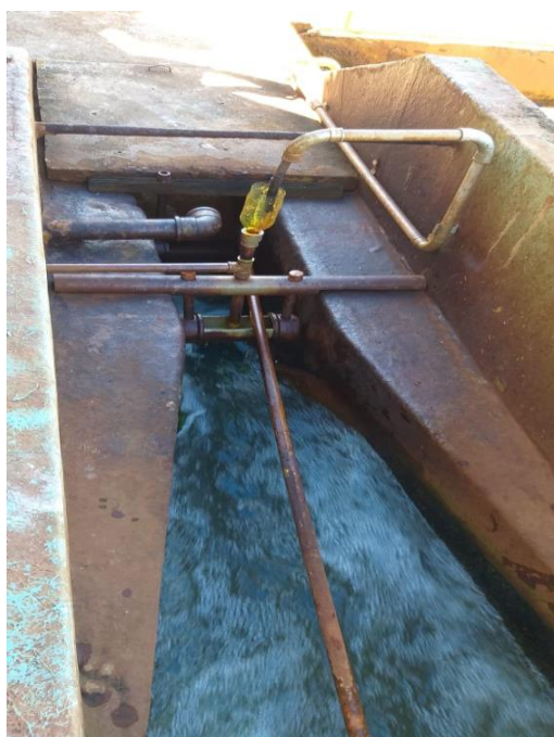
Figura 37 - Calha Parshall e adição de cloreto férrico
