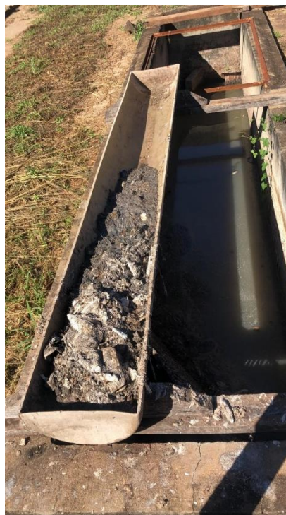
Figura 142 - Estação Elevatória de Esgoto – Estiva
