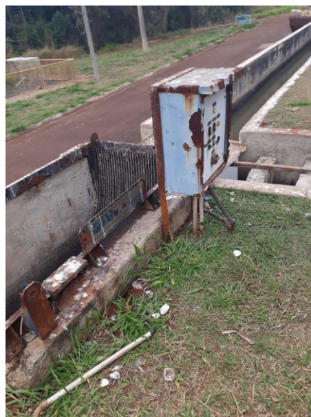
Figura 149 - Pannel do gradeamento automático em mau estado de conservação
