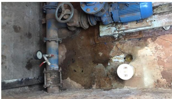
Figura 81 - Vazamentos no booster COHAB II
