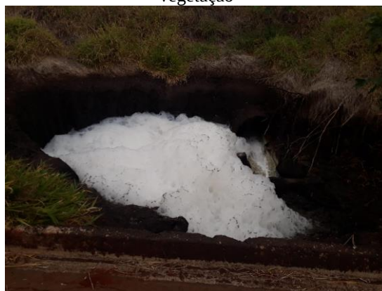
Figura 179 - Poço de visita que cedeu, formação de espuma
