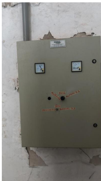
Figura 61- Caixa do pannel elétrico da EEAT COHAB I
