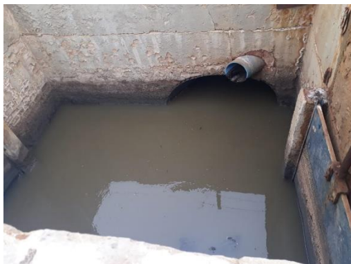
Figura 146 - Caixa de Passagem
