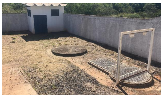
Figura 132 - Estação Elevatória de Esgoto – Athenas Paulista I
