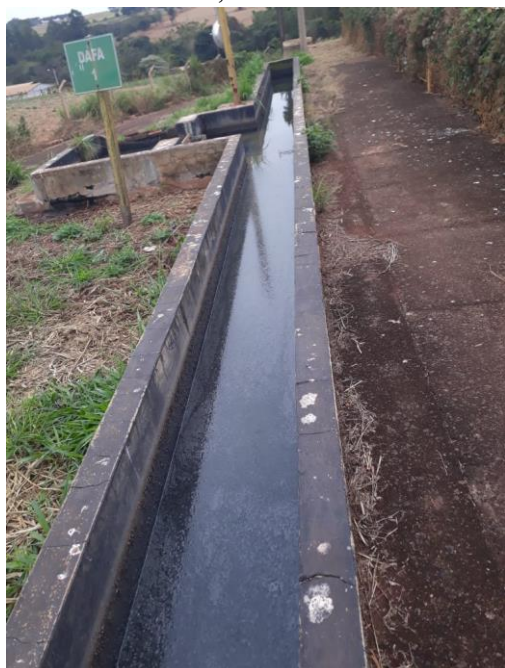
Figura 160 - Canaleta de entrada de efluente no DAFA obstruída
