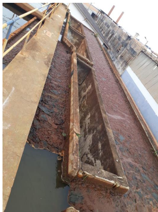
Figura 38 - Canaleta do Floculador
