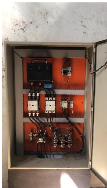
Figura 74 - Painel Elétrico da EEAT – Bomba do Buraco
