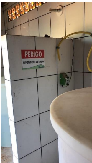
Figura 27 - Dosador de hipoclorito de sódio do poço da Rodoviária
