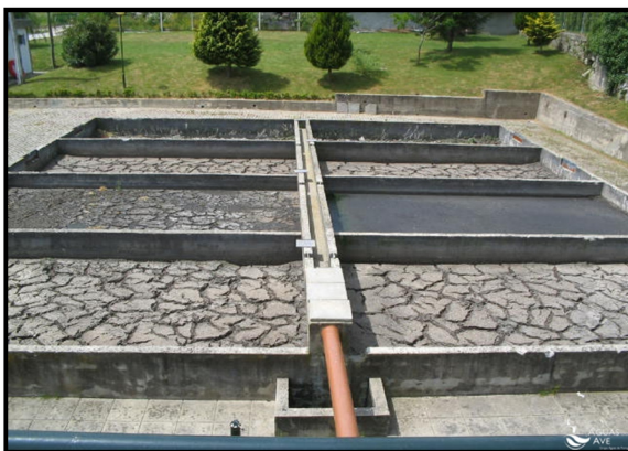
Figura 41. Leito de secagem de lodo
