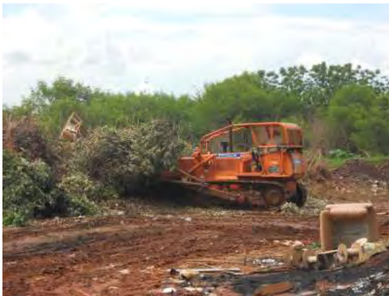
Foto 8-61. Máquina acondicionando os RPC dispostos de forma irregular sobre área do bairro Chácara Arco-Íris.
